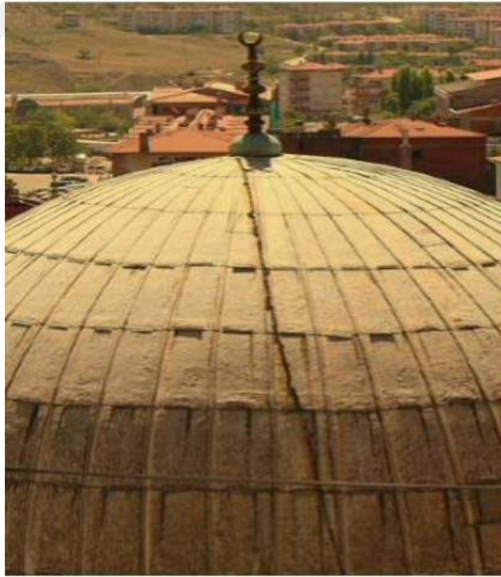
Şekil 6.11 Kubbede hasar oluşumu
