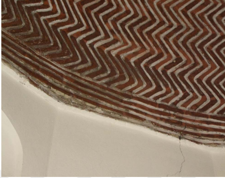
Şekil 8.28 Yapının iç mekandan kubbe çatlağı
