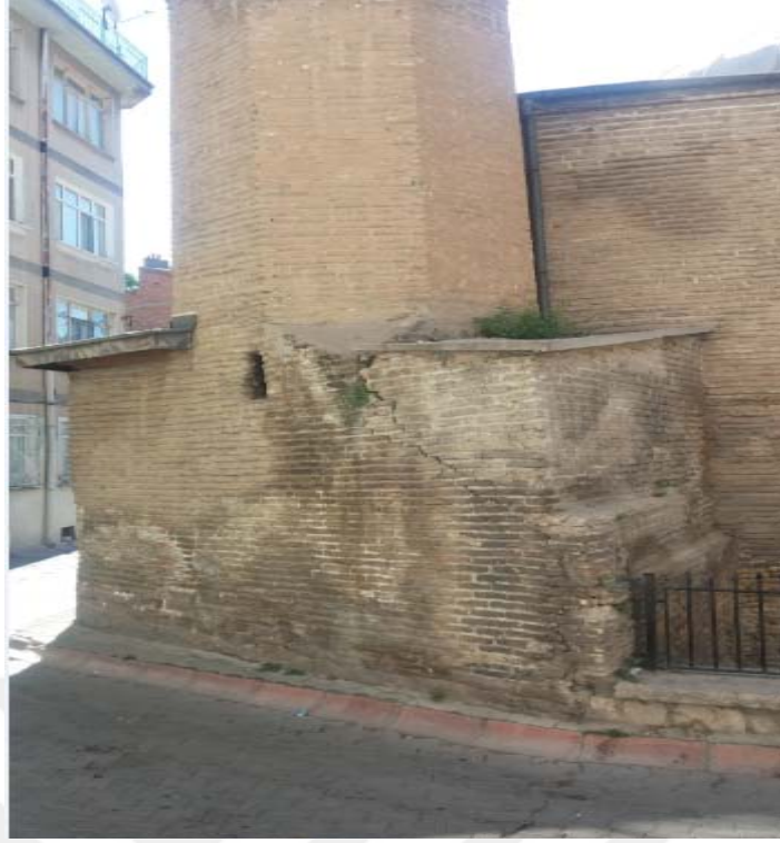
Şekil 8.30 Yapının minare alt taban duvarındaki çatlaklar
