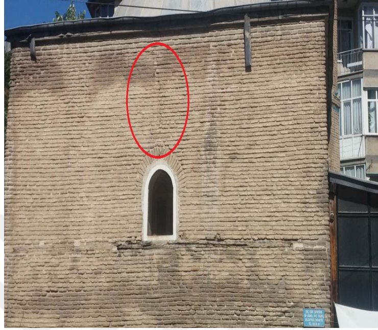
Şekil 8.26 Yapının doğu cephesindeki mevcut pencere üstü çatlağı
