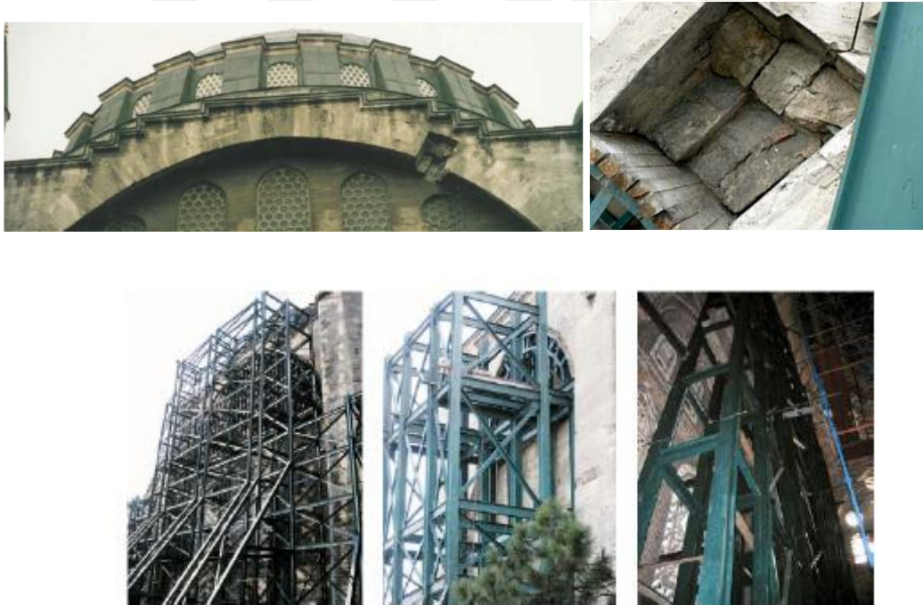
Şekil 2.8. Edirnekapı Mihrimah Sultan Camii kemerinde oluşan hasar ve yapının askıya alınmış hali.
