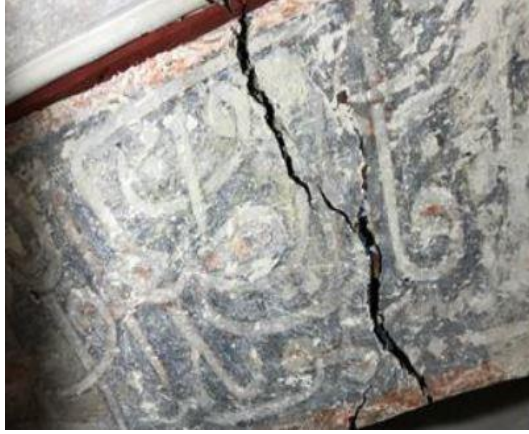
a) Kemer çatlağı
