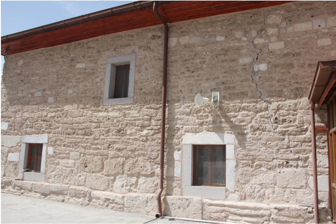
Şekil 3.1. Aksaray Eski Ulu Cami’nde yeraltı suyu değişimine bağlı oturma çatlakları
