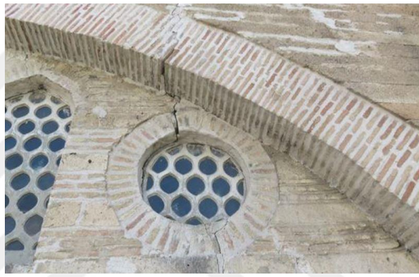
d) Kemer çatlağı
