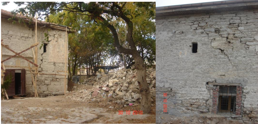
Şekil 4.1. 2011 yılı zemin iyileştirme çalışmaları öncesinde camide oluşan çatlaklar
