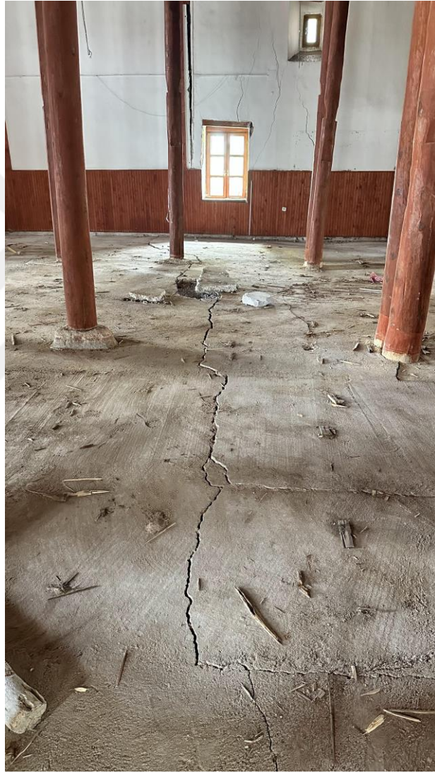
Şekil 4.35. Cami Doğu-Batı aksında bulunan oturma çatlağı
