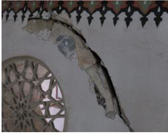
b) Duvar çatlağı
