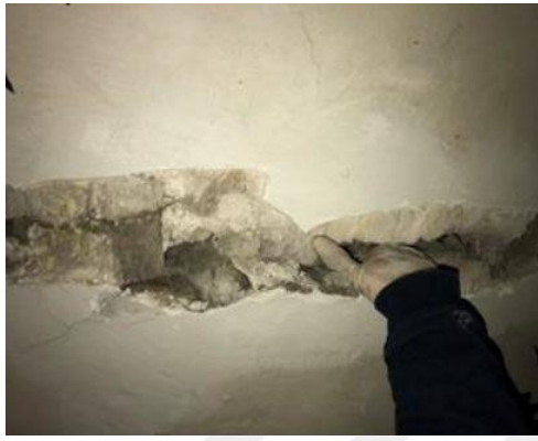
c) Duvar çatlağı
