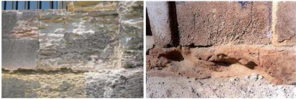
Şekil 4. 5. Atmosferin etkisiyle taşlarda oluşan bozulma örnekleri
