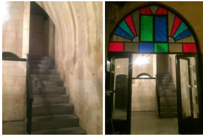
Şekil 6.68 Merdiven aydınlatmasının yetersiz kalması, Bayazhan
