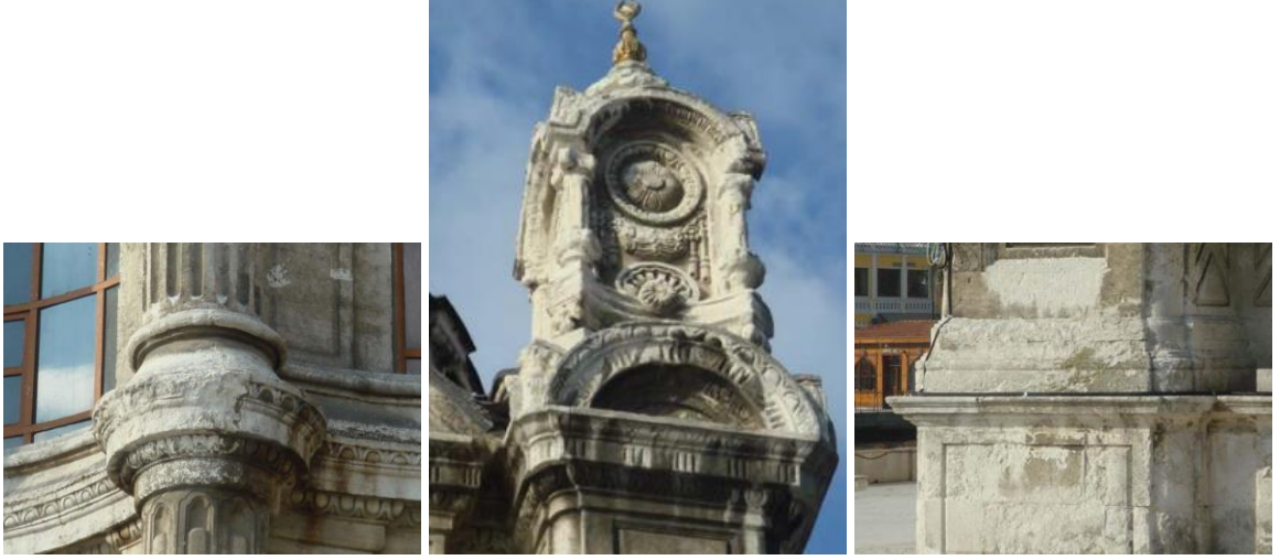
Şekil 1.23. Tarihi yapı duvarlarında (Ortaköy Camii) meydana gelen tuzlanma hasarı (Yıldırım, 2007).
