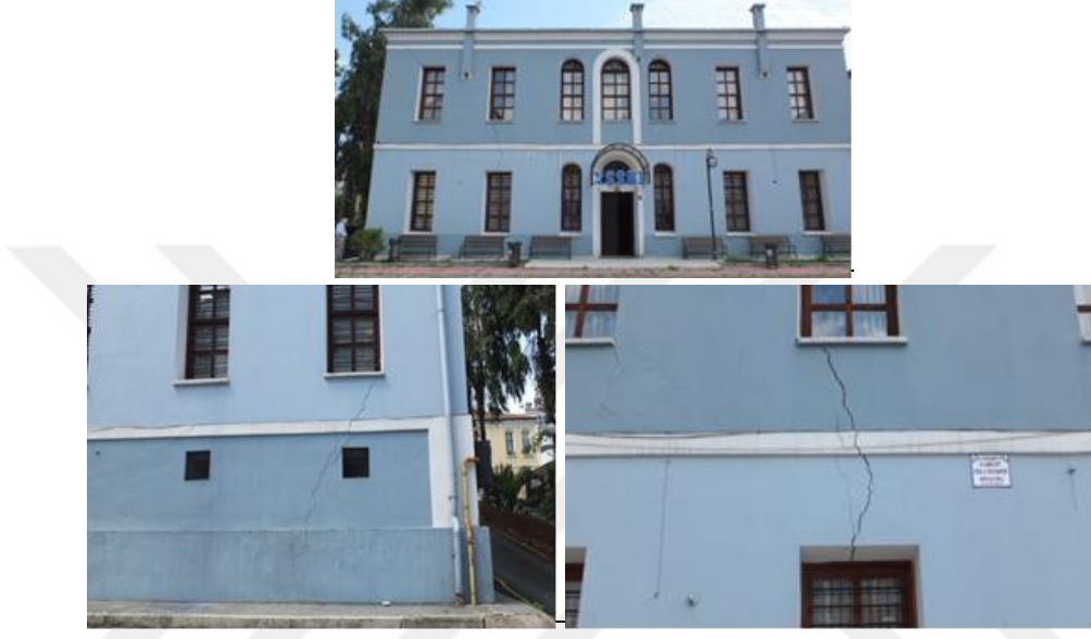
Şekil 1.21. Samsun Dumlupınar okulunda yapı etrafındaki kazı sonucu oluşan hasar
