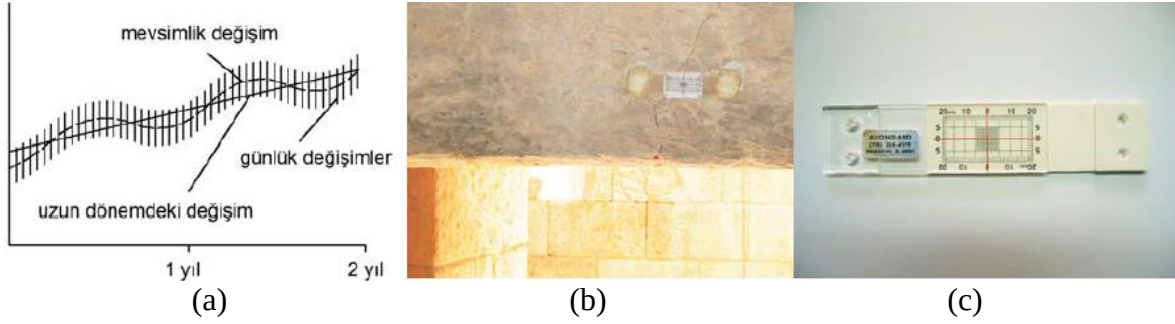
Şekil 1.45. Çatlak genişliği değişimi (a), kapı üstü lentosunda çatlak genişliği ölçümü (Efes Tiyatrosu) (b), çatlak genişliği ölçüm cetveli (c) (Sesigür vd., 2007).
