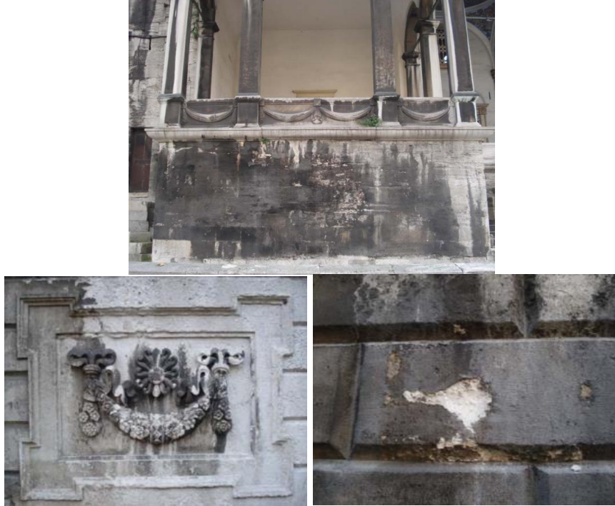
Şekil 1.25. Tarihi yapı duvarlarında hava kirliliği sonucu meydana gelen kararma ve kabuk oluşumu (Yıldırım, 2007).
