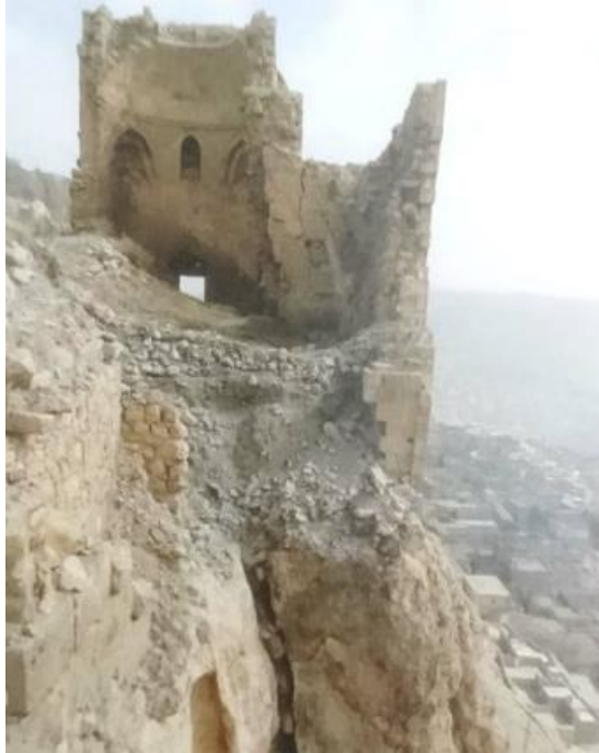
Şekil 1.26. Mardin'de üzerinde kale bulunan kayalardaki çatlak oluşumu ve taş kopması tehlikesi (Ahunbay, 2019).
