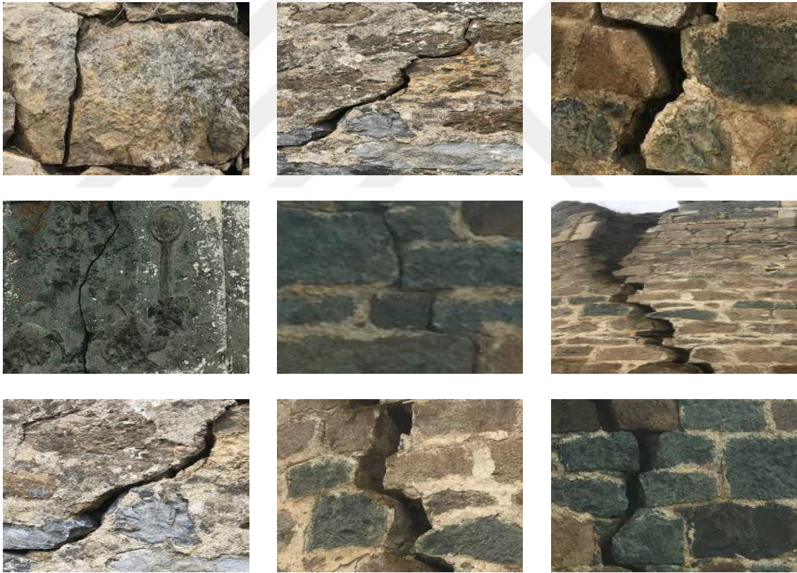
Şekil 21. Çatlak içeren görüntü örnekleri
