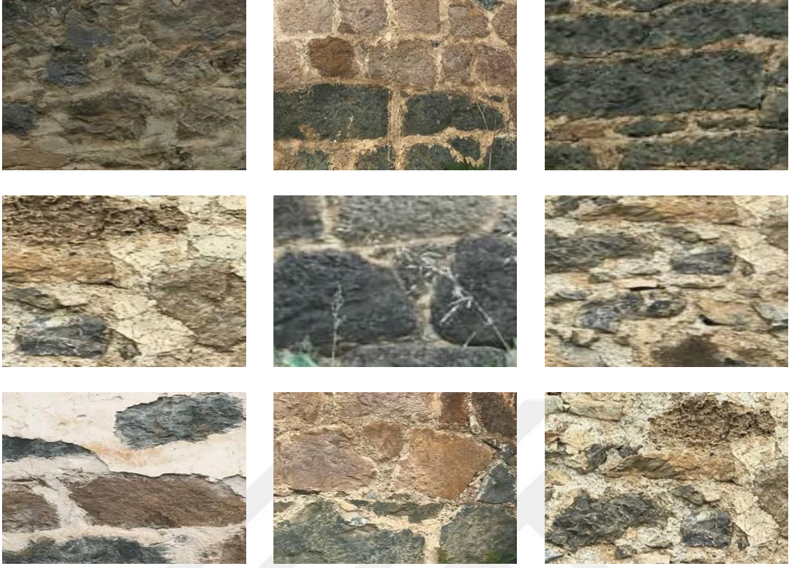
Şekil 22. Çatlak içermeyen görüntü örnekleri
