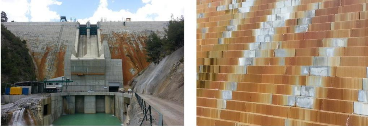
Fotoğraf 3.4 Kasımlar Barajı'ndaki Su Kaçakları 426
