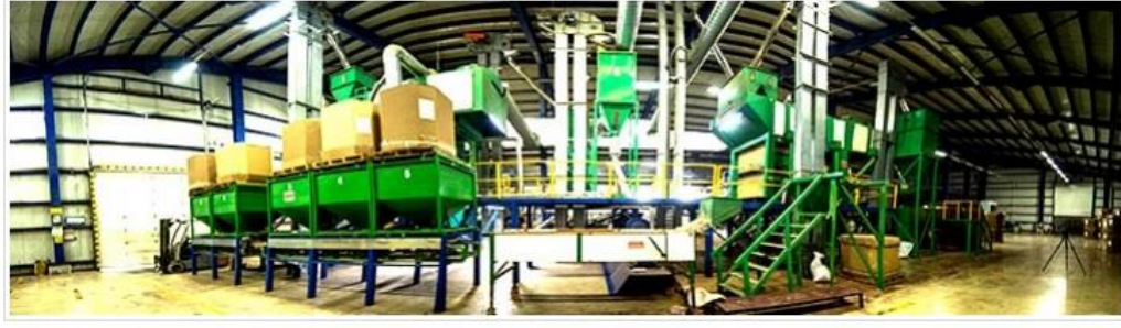
Şekil 26. Tohum üretim ve işleme tesisi (Konya Şeker).
