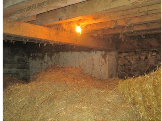
Şekil 3.7. Aydınlatma yakınındaki yanıcı malzeme (Vegte and ets., 2021)
