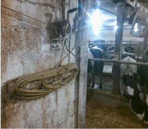
Şekil 3.6. Uzatma kablolarının yanlış kullanımı (Vegte and ets., 2021)
