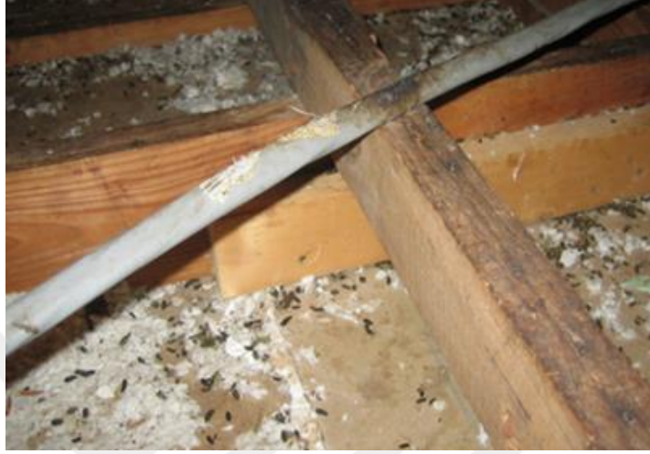
Şekil 4.13. Kemirgen zararı görmüş kaplamasız ve yanıcı malzeme ile temas halinde olan bir kablo. (URL-27)
