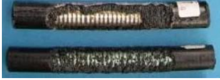
Şekil 4.14. Kemirgen zararı görmüş çelik zırh kaplamalı kablo. (URL-28)
