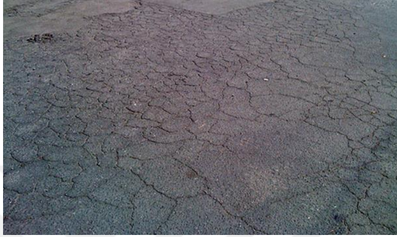
Şekil 5. Timsah sırtı çatlak (URL-3, 2020)
