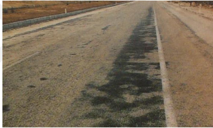
Şekil 9. Asfalt kaplamanın kusması
