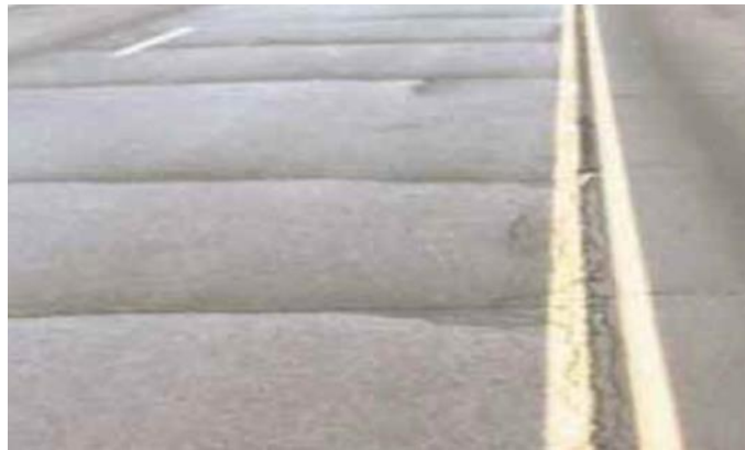
Şekil 7. Enine çatlaklar (Hanlı, 2009)
