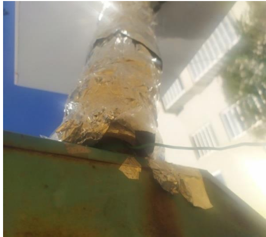
Şekil 5.27. Kolektör çıkış sıcaklığını ölçmek için yerleştirilen termokupl
