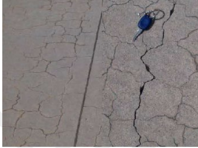
Şekil 1.3 İzmir Adnan Menderes Havalimanı pist ve taksi yol betonunda oluşan ASR çatlakları (Andiç-Çakır, 2007)
