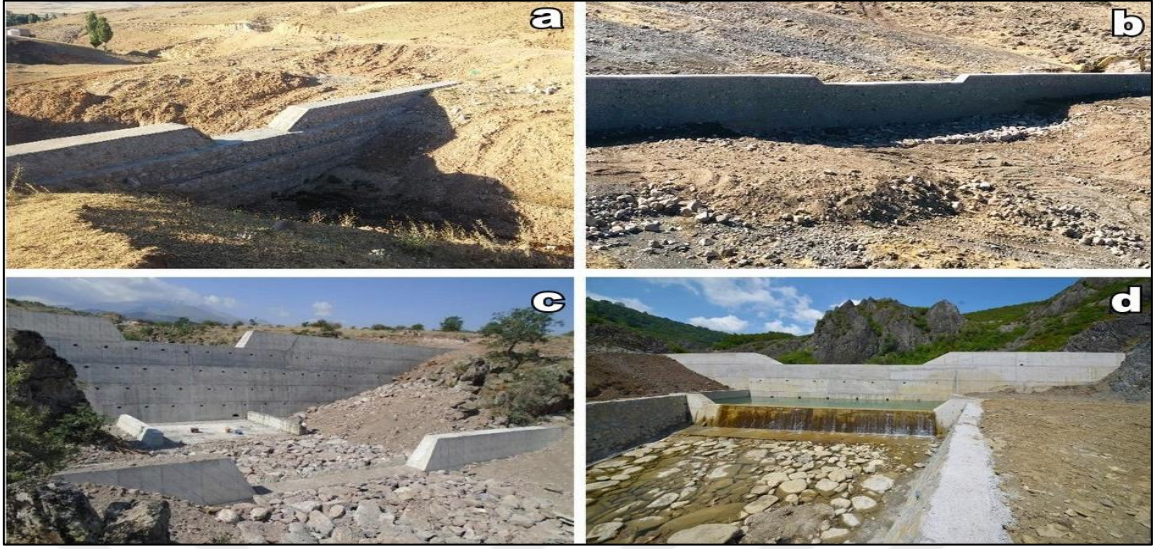
Şekil 1.15. Tersip bendi ile Ağrı Taşlıçay (a), Iğdır Halfeli (b), Kayseri Talas (c), Zonguldak Beycuma (d) bölgelerinde taşkın ve rusubat kontrolü
