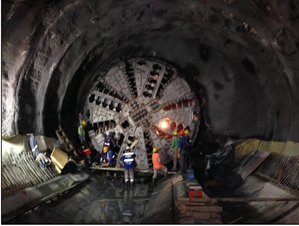
Şekil 4.2 : Kesici kafanın istasyon girişindeki görünümü.
