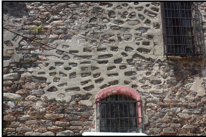
Şekil 3.13. Dayıoğlu Hamamı'nın Cephesindeki Beton Derzler (Asiltürk, 2023)
