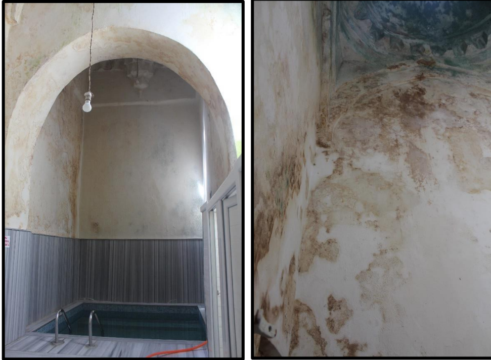
Şekil 3.41. Nasuhpaşa Hamamı Sonradan Eklenen Havuz (Asiltürk, 2023) Şekil 3.42. Nasuhpaşa Hamamı'nın Duvarındaki Bozulmalar (Asiltürk, 2023)
