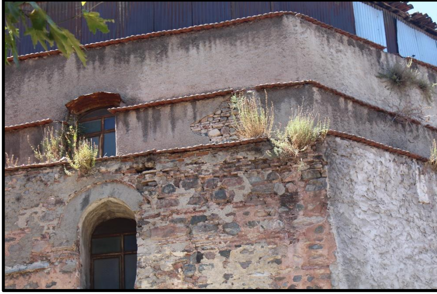
Şekil 3.215. Davutpaşa Hamamı'nın Cephesindeki Bozulmalar (Asiltürk, 2023)
