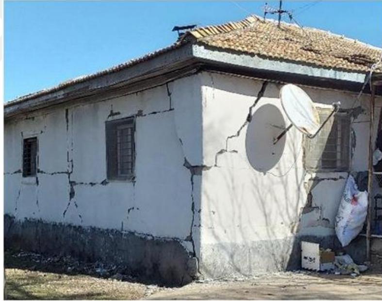
Şekil 3.15 Kahramanmaraş'ta depremde hasar alan yığma bina (Yetkin, 2024)
