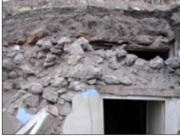
Şekil 11. Toprak çatı hasarı
