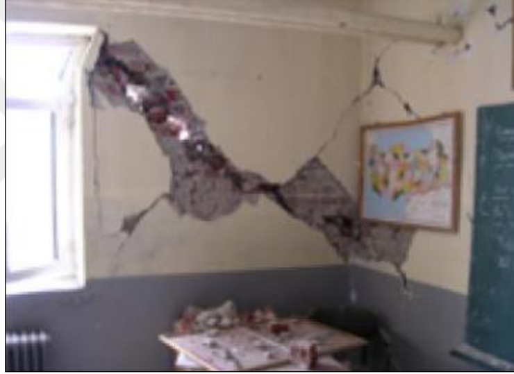
Şekil 13. Çekme etkisindeki duvar hasarı
