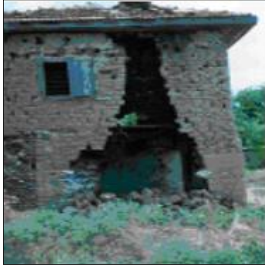
Şekil 12. Hatılsız duvar hasarı
