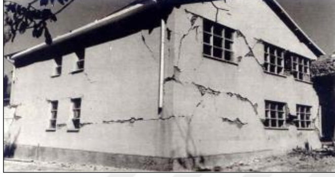
Şekil 14. Boşluklardan oluşan duvar hasarı
