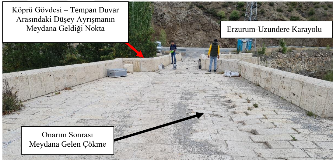
Şekil 3.41. Pehlivanlı Köprüsü tempan duvarında onarım sonrası yeniden meydana gelen çökmeye ait bir görsel.
