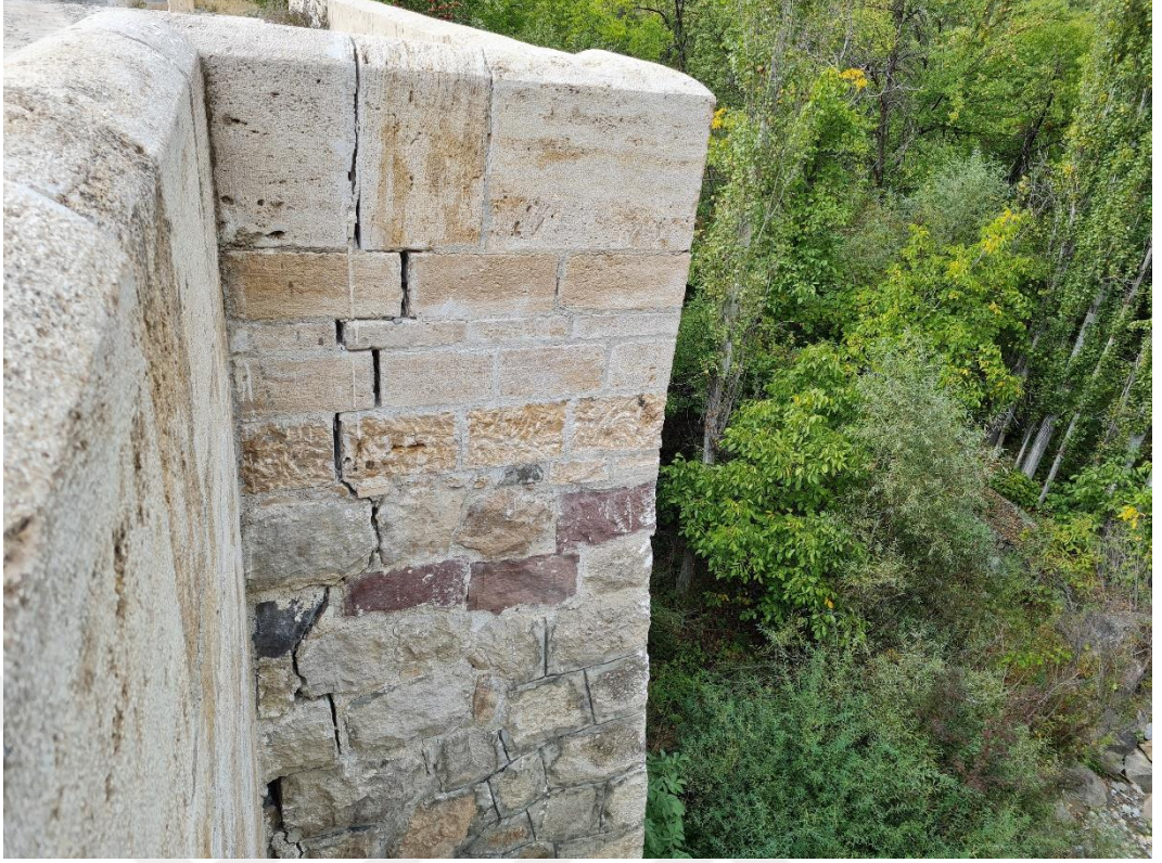
Şekil 3.42. Tempan duvar onarımı sonrası köprü gövdesi ile tempan duvar arasındaki düşey ayrışmanın yakın plan bir görüntüsü.
