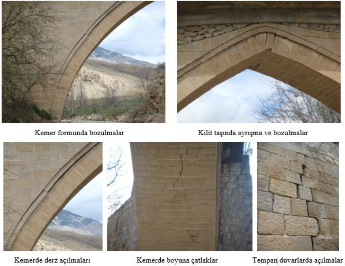
Şekil 3.29. Kireçli Köprüsü restorasyon öncesi hasarlarına ait bazı görüntüler (Bayraktar 2012).
