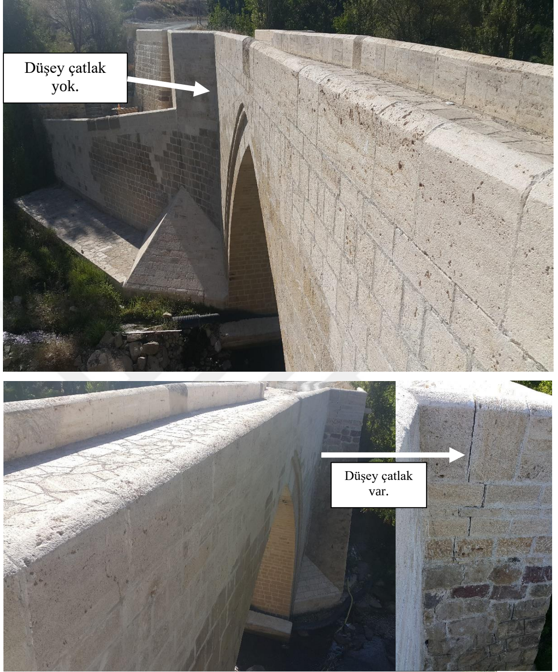
Şekil 3.37. Pehlivanlı Köprüsü restorasyonundan ~2 yıl sonrasında çökme meydana gelen tempan duvarın her iki tarafına ait görüntüler.
