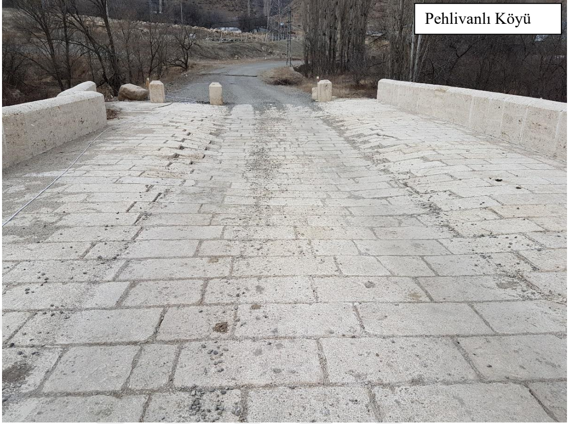
Şekil 3.36. Pehlivanlı Köprüsü restorasyonundan ~ 2 yıl sonrasında tempan duvarda meydana gelen çökme görüntüsü.
