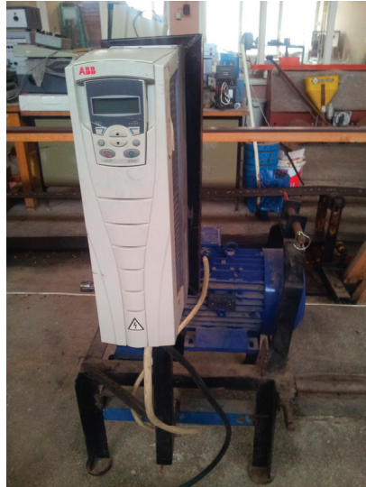
Şekil 3.5. Fan tahriki için kullanılan elektronik kontrollü redüktör düzeneği
