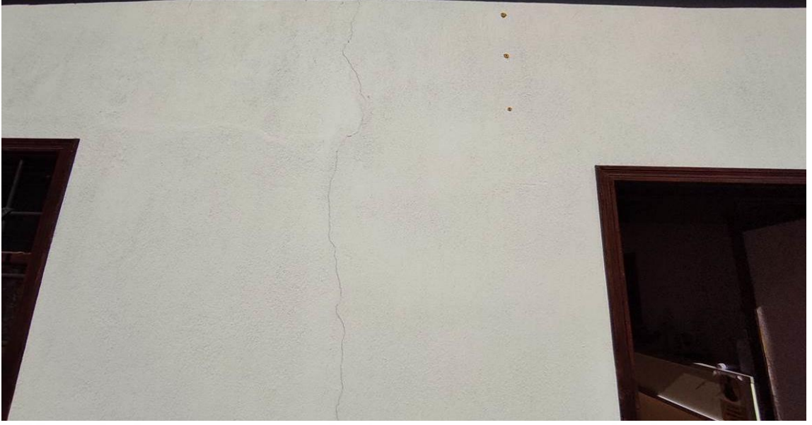
Şekil 4.4. Ebu İshak Kazeruni Zaviyesi Duvarda Görülen Deformasyon.
