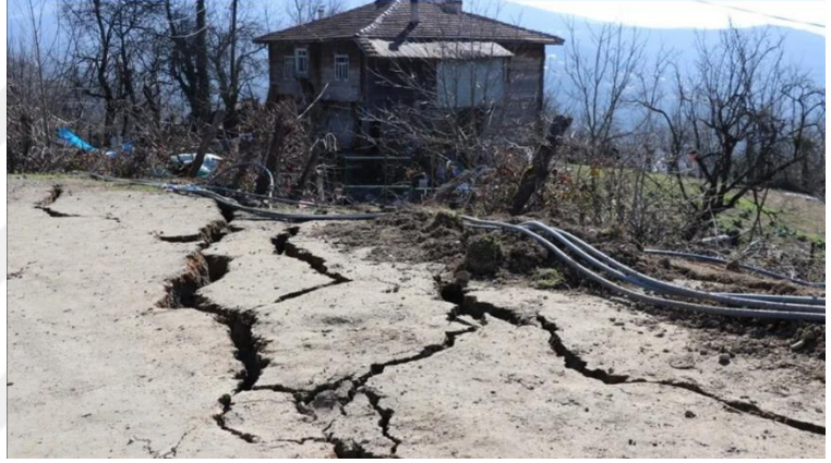
Görsel 3.6 Karabük'te heyelan nedeniyle 17 ev tedbir amaçlı boşaltıldı. 12
