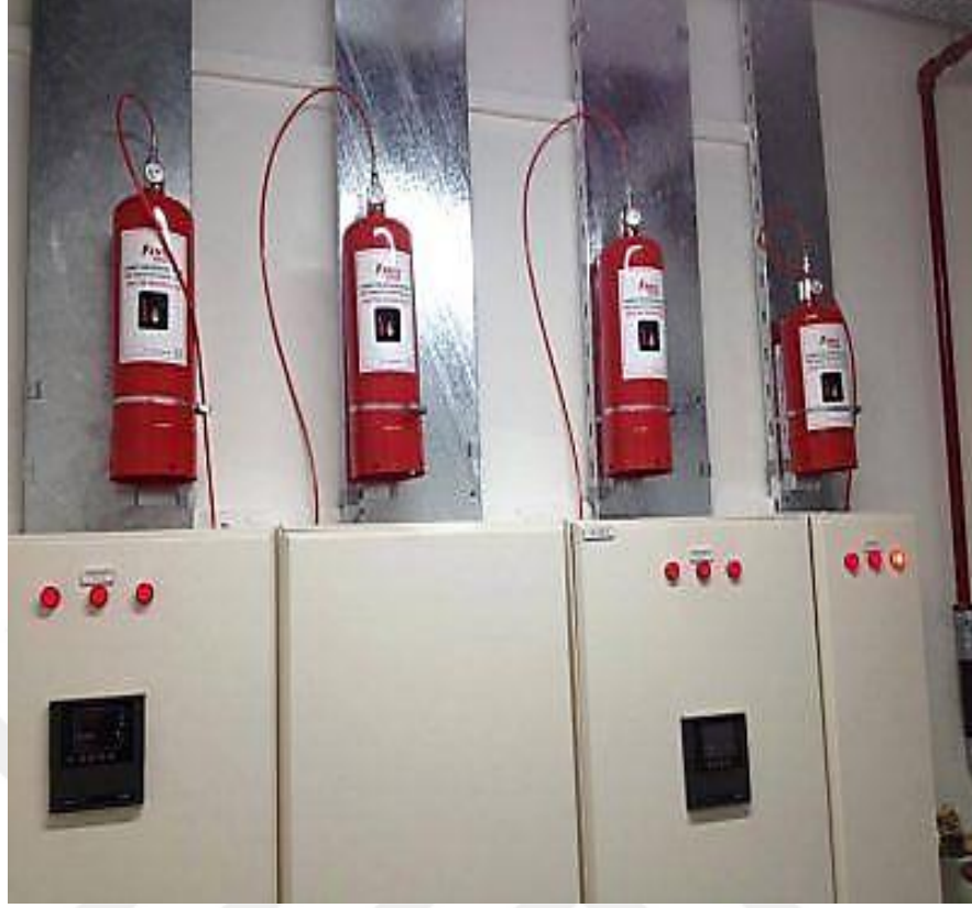
Şekil 4.7. Gazlı yangın söndürme sistemleri örnek uygulama
