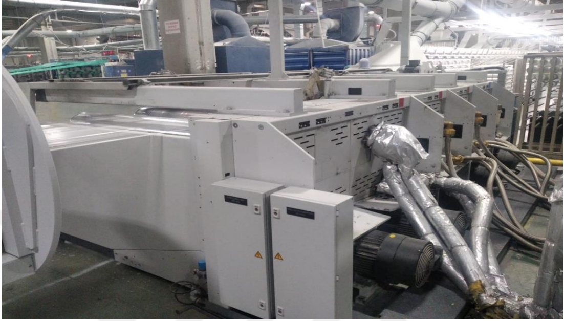
Şekil 6: Kızgın Yağı Silindirlere Taşıyan Yalıtımlı Boruların Görseli.
