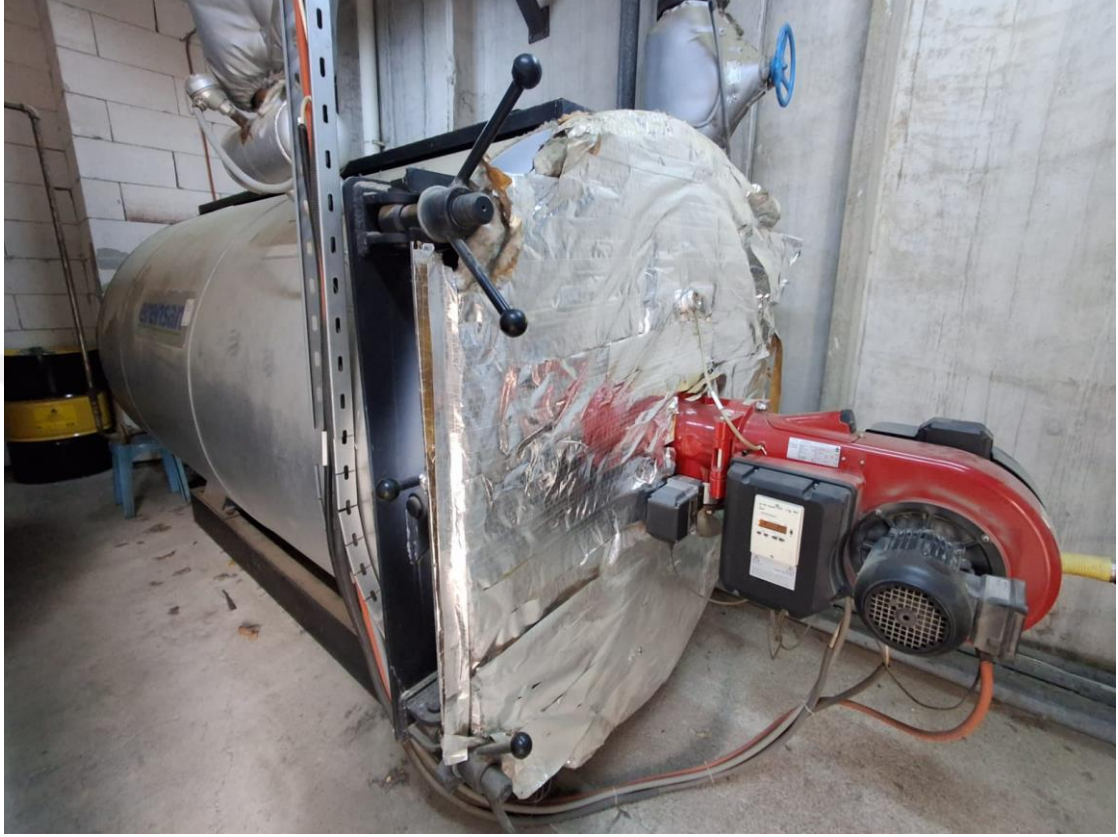
Şekil 4: Analizi Yapılan Sistemin Kızgın Yağ Ünitesi Kazan Görseli.
