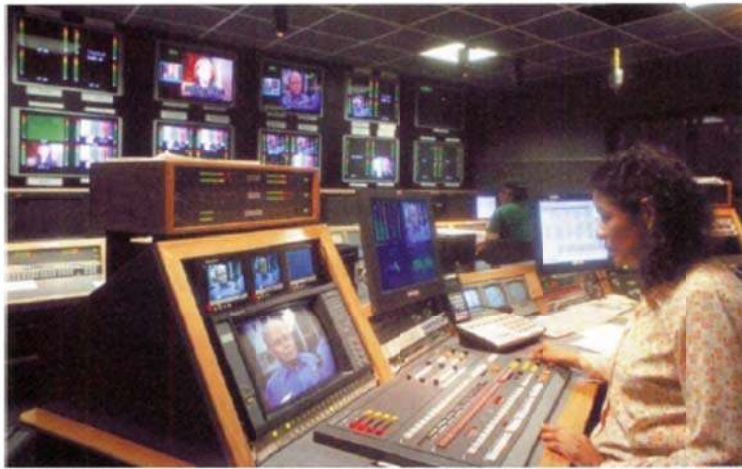
Resim 2.5. Master kontrol odası [9]
