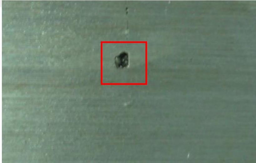
Şekil 2.26 Saçma hatası (Termit Kaynağından Alınan Kesit).
