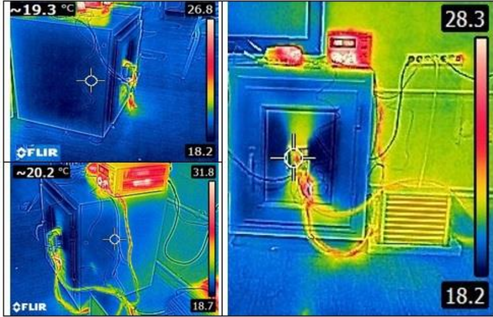
Şekil 41. Soğutucu dolabın çeşitli çalışma koşullarında termal kamera görüntüleri
