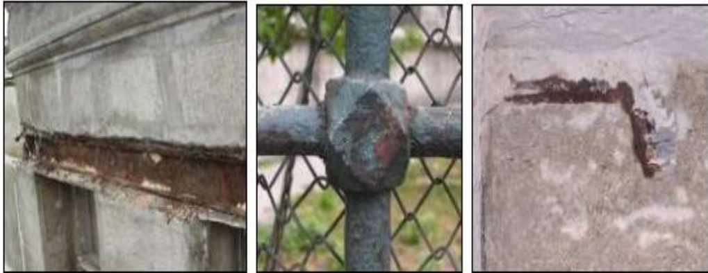
Şekil 4.13. Demir Elemanlarda Görülen Korozyon (MEB, 2013, S. 22).
