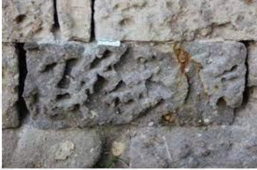
Şekil 4.3. Taş Yapıda Aşınma (Hasbay ve Hattap, 2017, S. 30).
