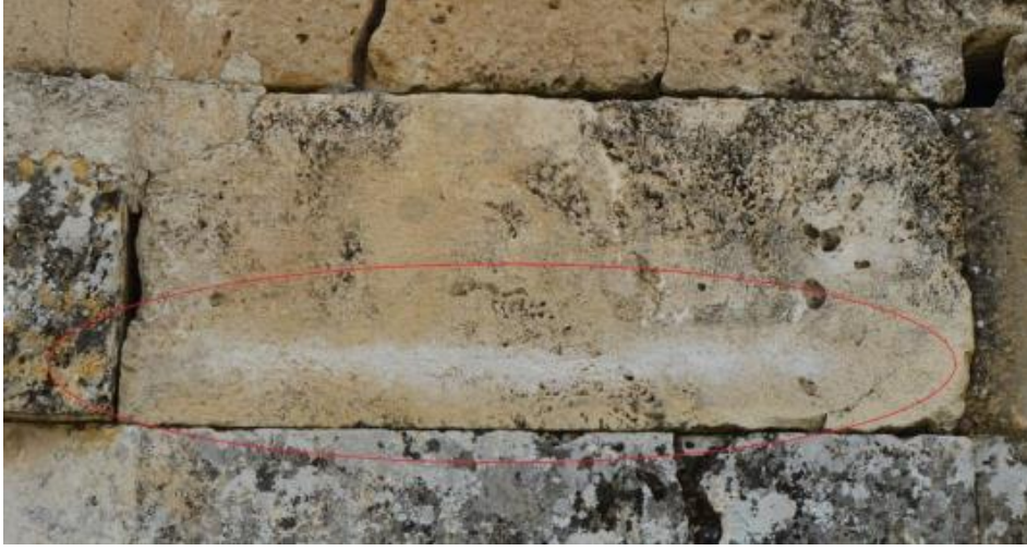
Şekil 4.8. Taş Yapıda Çiçeklenme Örneği (Erdem, 2016, S. 20)
