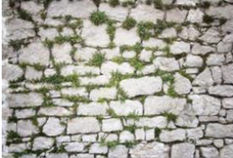
Şekil 4.16. Derz Arasında Ot Oluşumu (Hasbay ve Hattap, 2017, S. 39).
