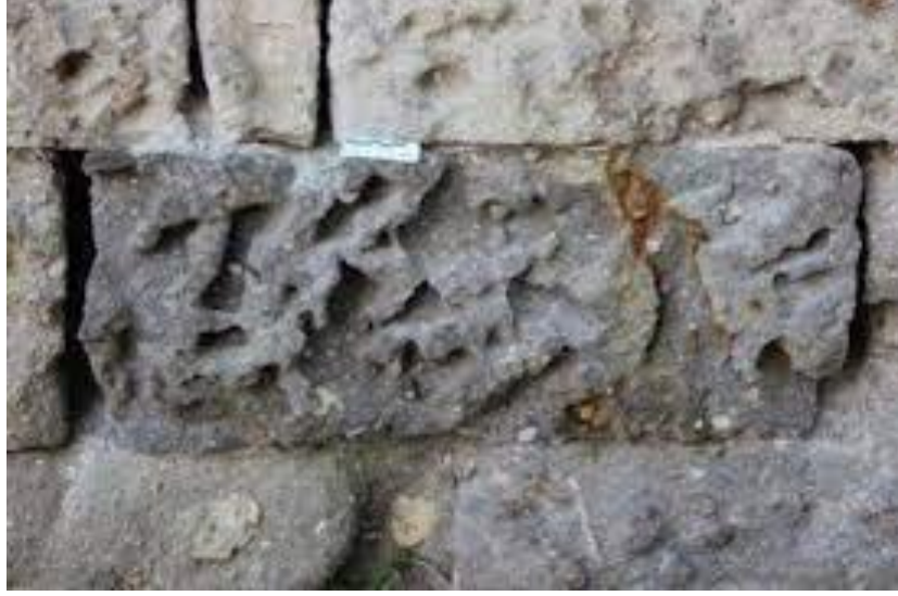
Şekil 4.3. Taş Yapıda Aşınma (Hasbay ve Hattap, 2017, S. 30).
