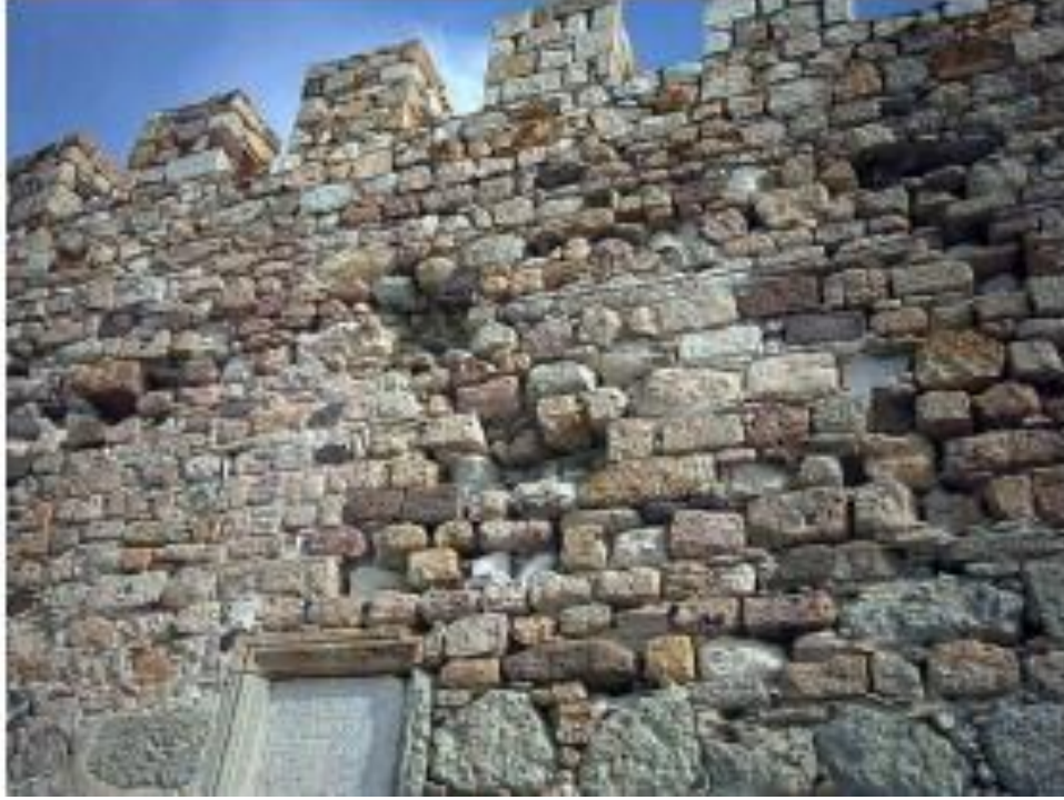
Şekil 4.5. Taş Yapıda Derz Boşalması (Hasbay ve Hattap, 2017, S. 31).
