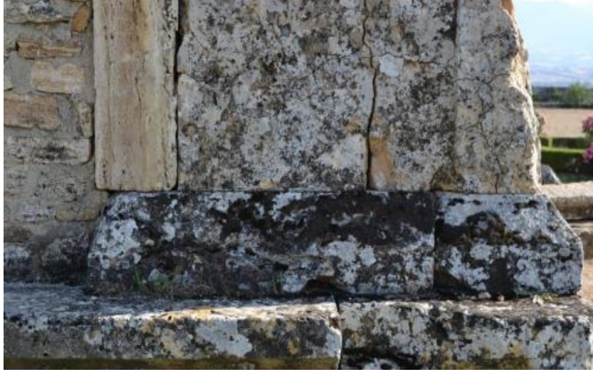
Şekil 4.15. Taşta Oluşan Liken Ve Yosun Örneği (Erdem, 2016, S. 30)
