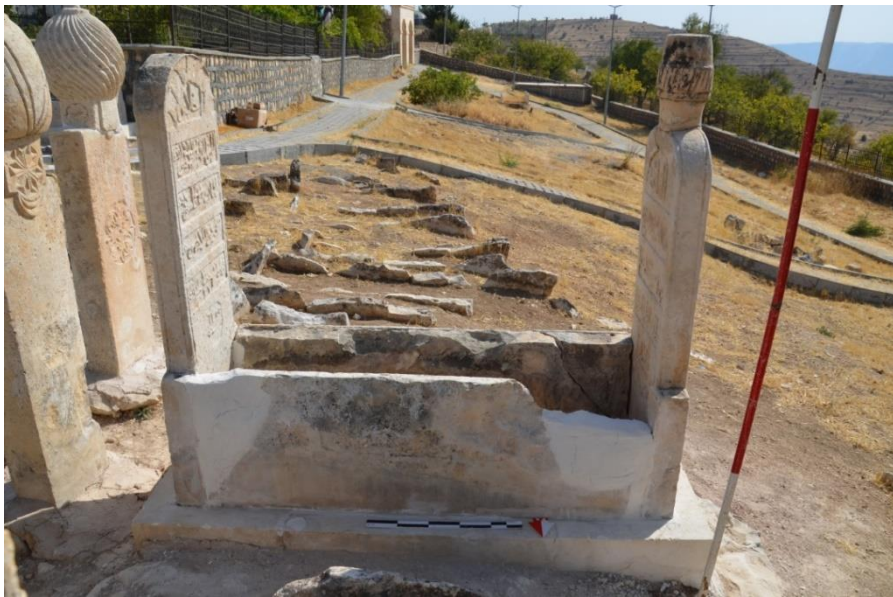
Şekil 5.35. OK18 Numaralı Mezarın Restorasyon İlkelerine Uymayan Çimento Harç ve Demir Kenetin Kaldırılması Sonrası Durumu
