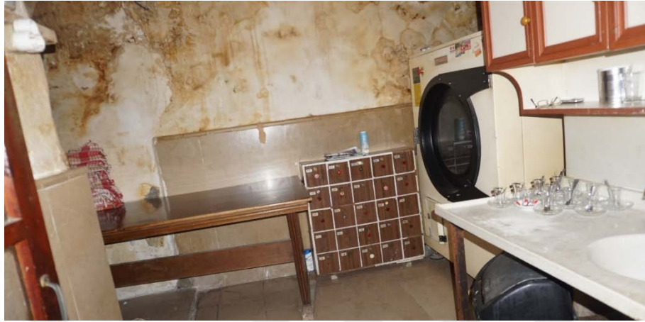
Şekil 5.24. Hamam duvarındaki renk değişimi ve rutubet sorunu
