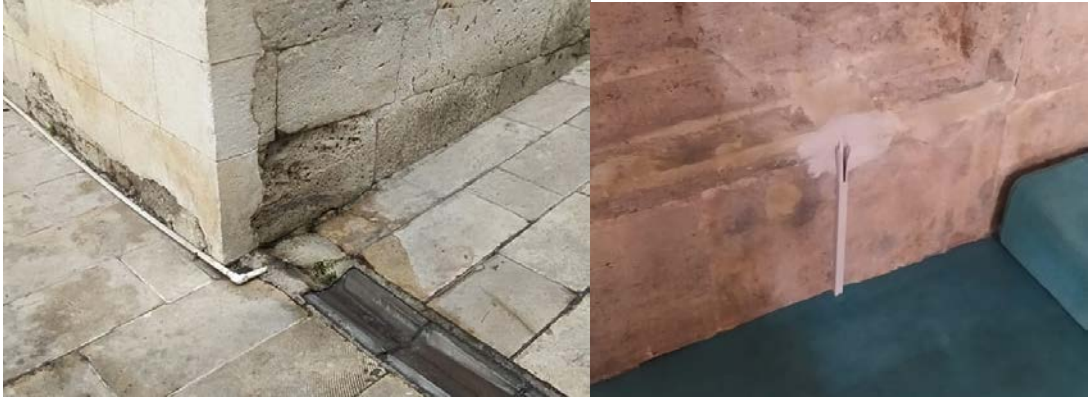
Şekil 5.31. Tesisat için taş malzemeye verilen zararlar
