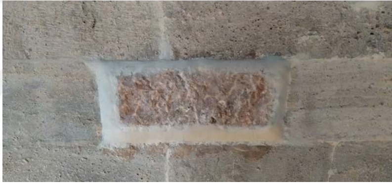
Şekil 5.27. Cami duvarındaki malzeme kaybı
