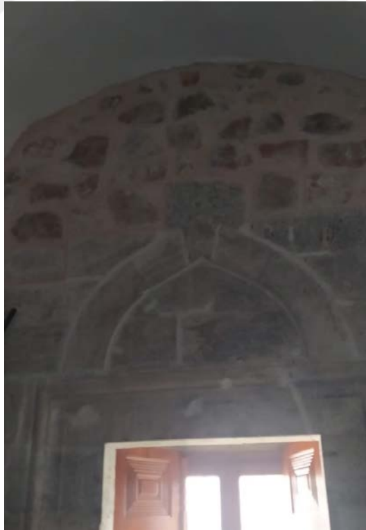
Şekil 5.28. Doğu cephesindeki yanlış malzeme ile onarımı yapılmış kısım
