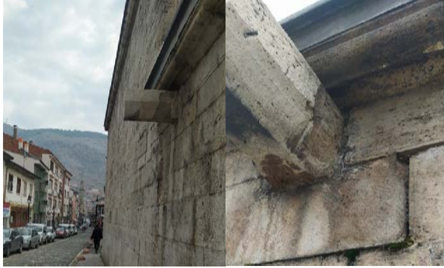
Şekil 5.30. Yanlış çörten birleşimi sonucu oluşan nem problemleri
