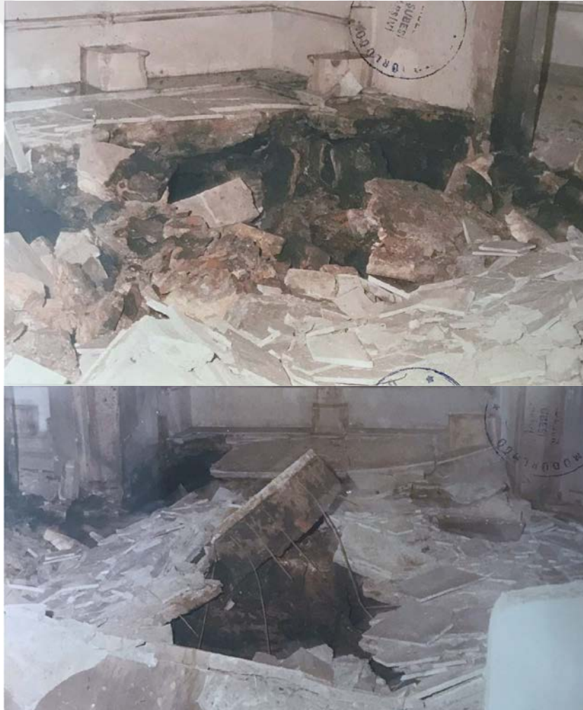
Şekil 5.15. Patlama sonucunda zarar göre hamam zemin fotoğrafları (Aktaran: Altunsoy, 2021)
