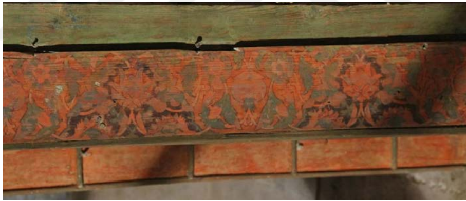
Şekil 5.32. Ahşap kadınlar mahfilindeki bozulmalar
