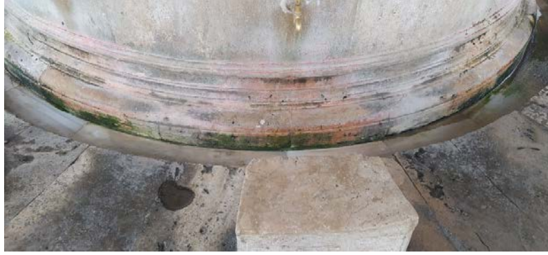
Şekil 5.26. Şadırvanın havuz kısmındaki yosunlaşma, renkleneme ve çatlamlar
