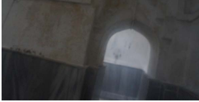
Şekil 4.65. Sıcaklık kısmına geçiş kapısı
