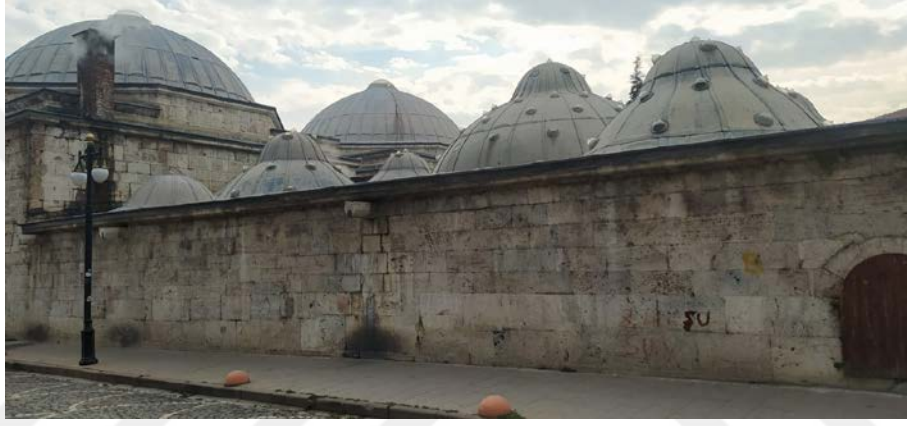
Şekil 5.23. Hamam doğu cephesindeki kirlenmeler
