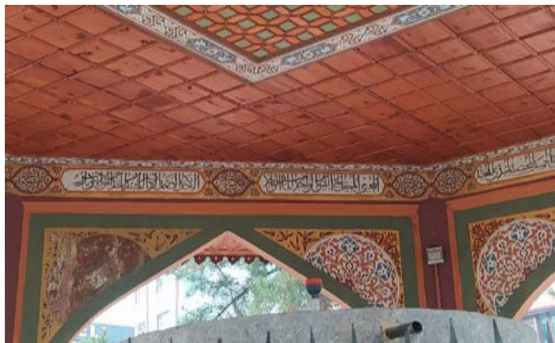
Şekil 5.25. Şadırvanın kalem işi süslemelerindeki bozulmalar
