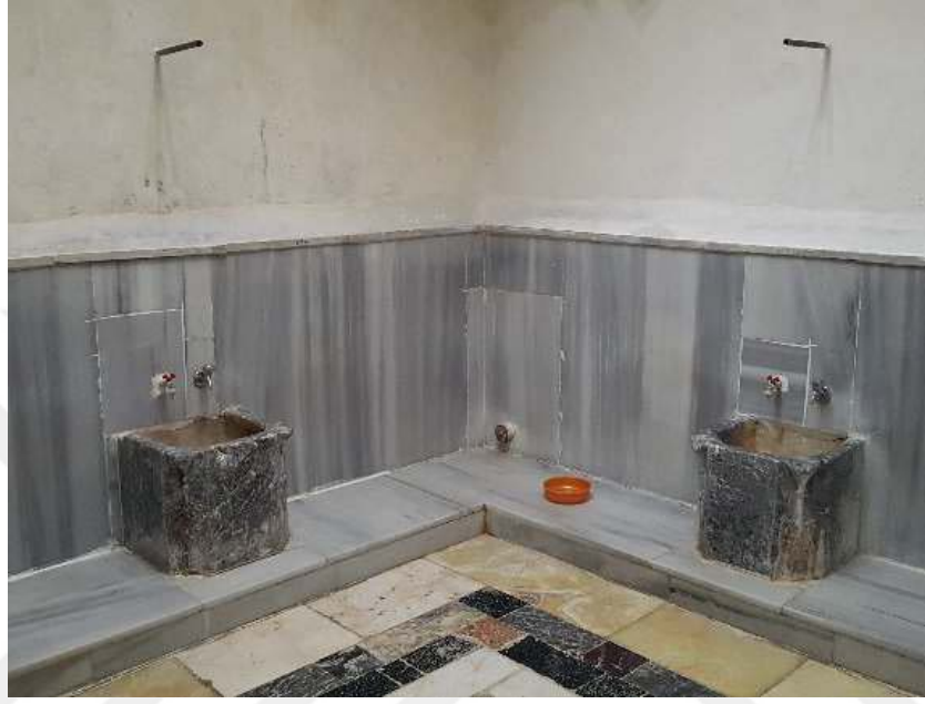
Şekil 5.29. Yanlış malzeme ile onarılan zemin, duvar kaplamaları ve kurnalar
