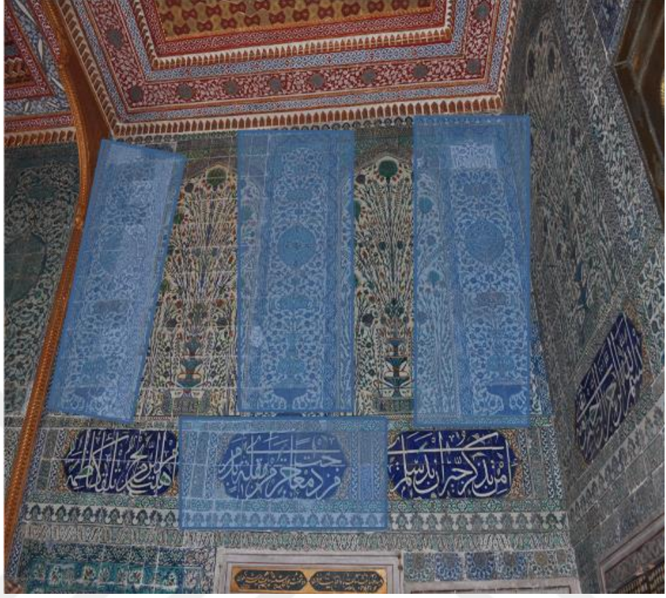
Resim 171. Veliyht Dairesi 2.Oda Duvar 1
