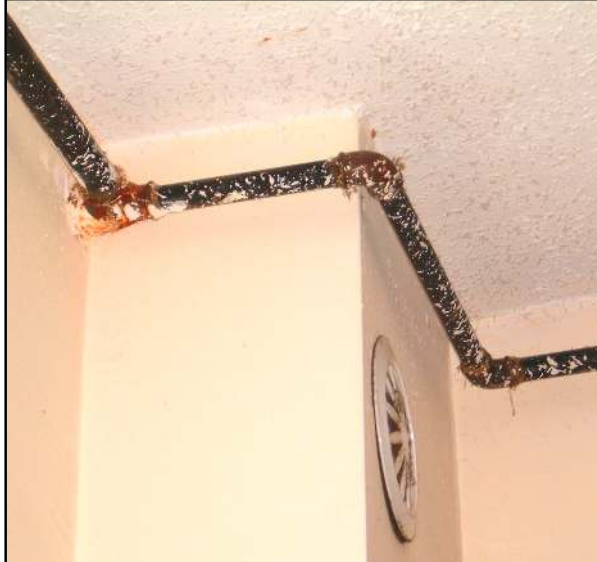
Resim 7.20. Mutfakta tavan- duvar birleşiminden geçen doğalgaz borusunun tasarımda planlanmadığı için sonradan eklenmesinde yaşanan malzeme ve işçilik kalitesi
