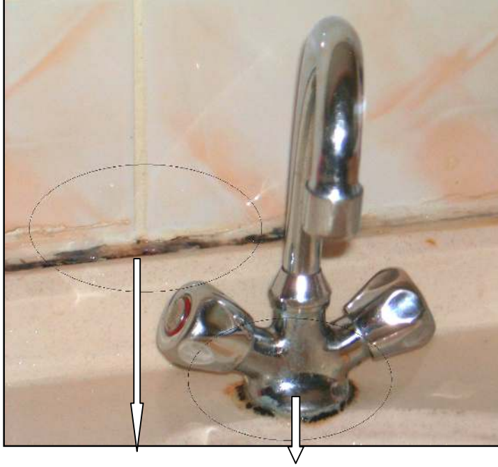
Resim 7.9. Mutfaktaki musluk- eviye birleşiminde ve eviye-duvar kaplaması birleşimindeki yalıtım malzeme ve işçilik kalitesizliği
