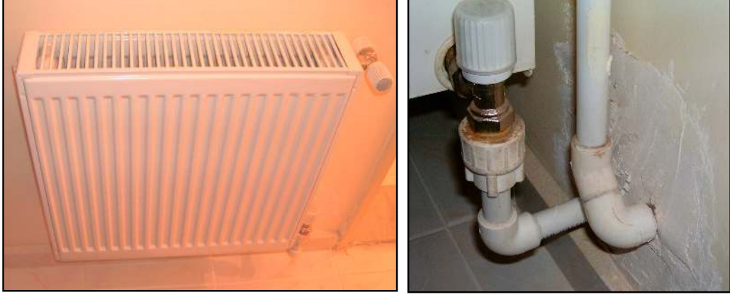
Resim 7.7. Sonradan takılan kalorifer peteklerinde duvar- boru birleşiminde meydana gelen problem
