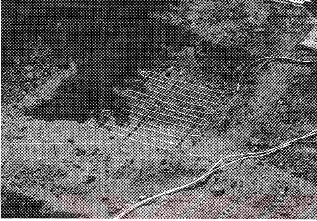
Şekil 4.12. 1 m Derinliğindeki Toprak Isı Değiştiricisinin Fotoğrafi
