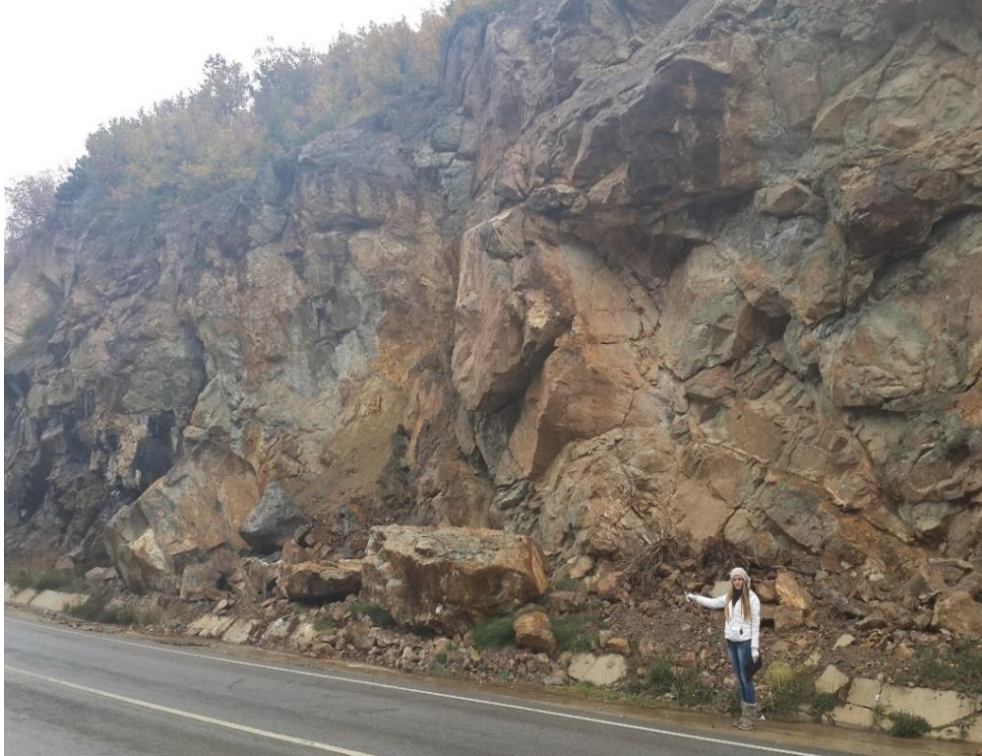
Şekil 2.11. Şev kenarlarında kopup düşmüş bloklar
