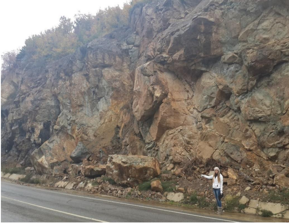
Şekil 2.11. Şev kenarlarında kopup düşmüş bloklar
