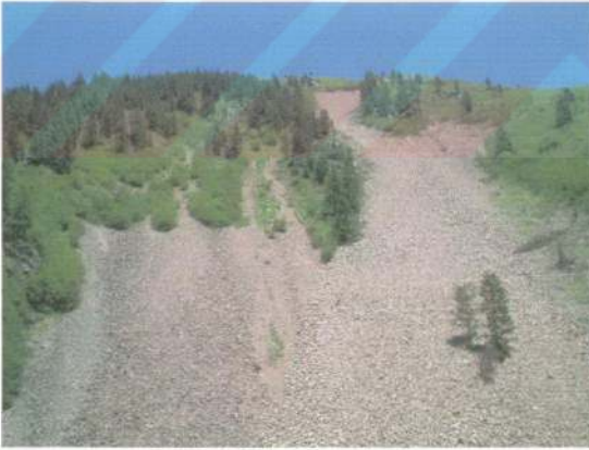
Şekil 30. Pazarlık Yaylası'nda yol yapım çalışması nedeniyle oluşan tahribat
