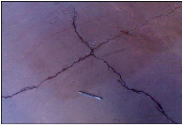
Şekil 20. Oturma rötresi çatlağı (Yıldırım, 2017).
