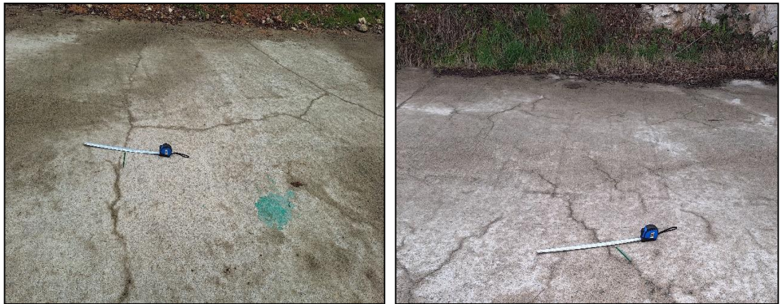
Şekil 39. Araştırma alanında görüntülenen 2 ve 3 nolu çatlak tipleri
