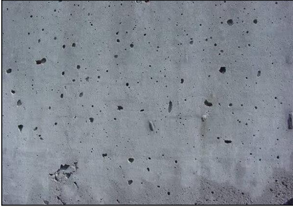
Şekil 25. Beton yüzeyinde kabarcık oluşumu (URL-1).
