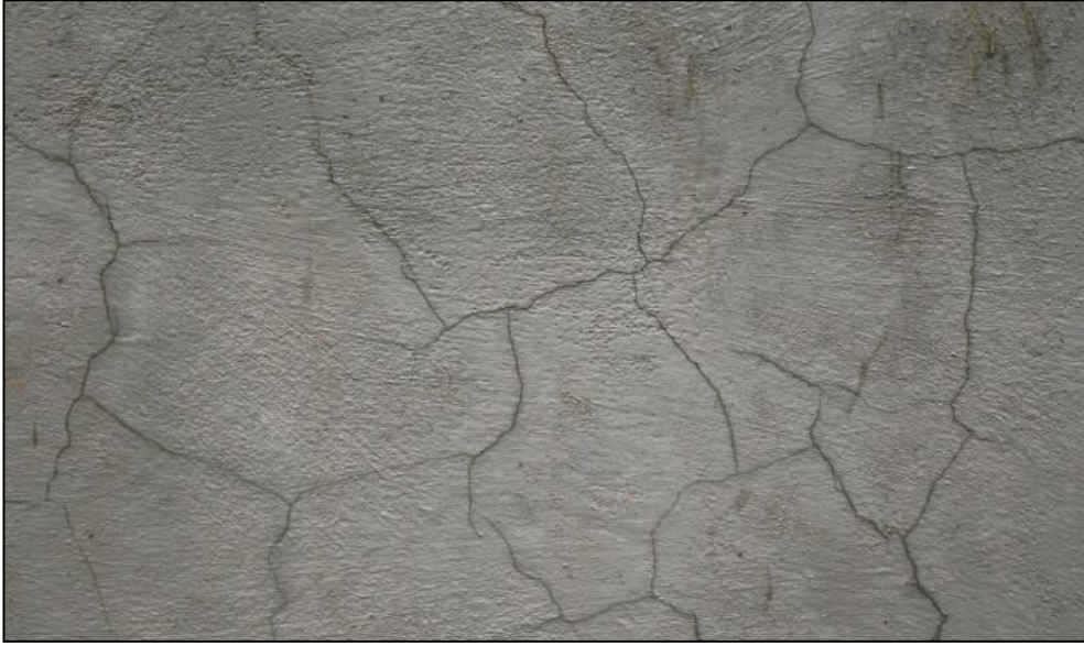
Şekil 17. Plastik rötre çatlağı (Şahin, 2024).
