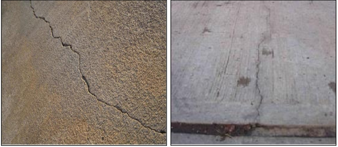
Şekil 19. Kuruma rötresi çatlağı (Şahin, 2024), (Ekinci, 2022).
