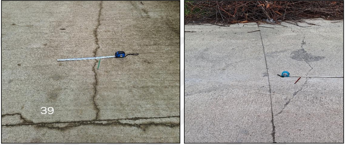
Şekil 41. Araştırma alanında görüntülenenen 6 nolu çatlak tipi
