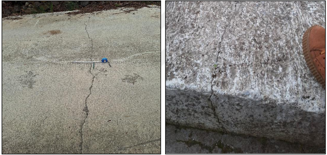
Şekil 38. Araştırma alanında görüntülenen 1 nolu çatlak tipi
