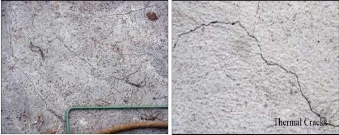
Şekil 18. Termal rötre çatlağı (Ekinci, 2022).
