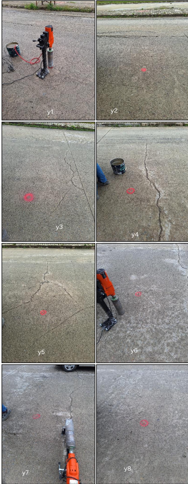
Şekil 35. Yolgören mahallesinde belirlenen çalışma alanında çatlaklı kısımlara yakın bölgelerde alınan karot yerleri
