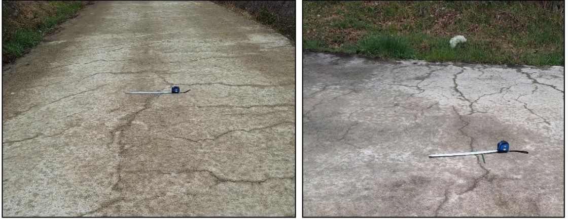
Şekil 40. Araştırma alanında görüntülenenen 4 ve 5 nolu çatlak tipleri
