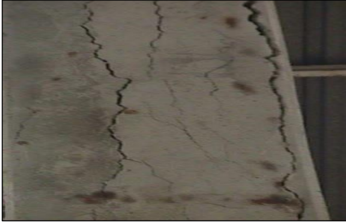
Şekil 22. Donatı korozyonu çatlağı (Ekinci, 2022).
