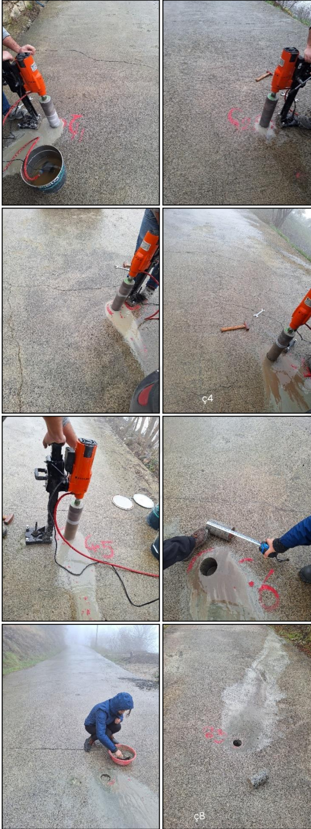
Şekil 31. Çal mahallesinde belirlenen çalışma alanında çatlaklı kısımlara yakın bölgelerde alınan karot yerleri
