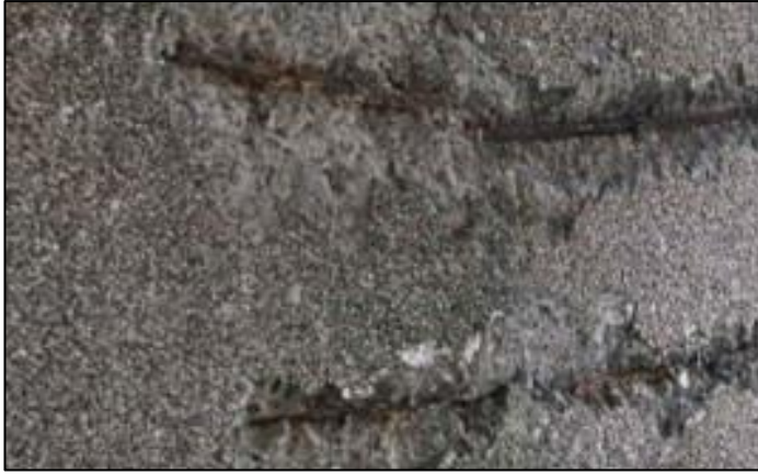
Şekil 21. Karbonatlaşma büzülmesi rötire çatlakları (Ekinci, 2022).
