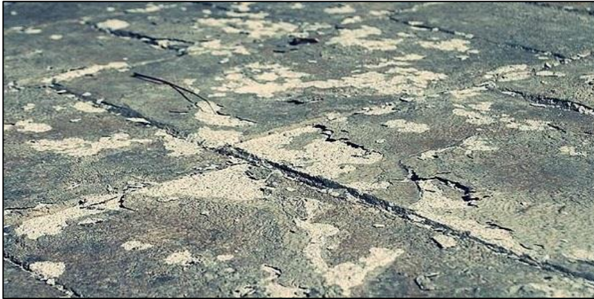
Şekil 23. Donma ve çözünme etkisine maruz kalmış beton (URL-2)
