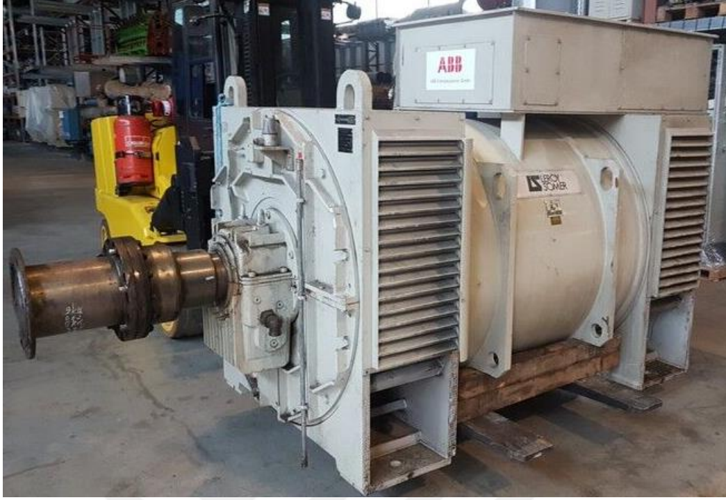
Resim 3.3 Leroy Somer jeneratör
