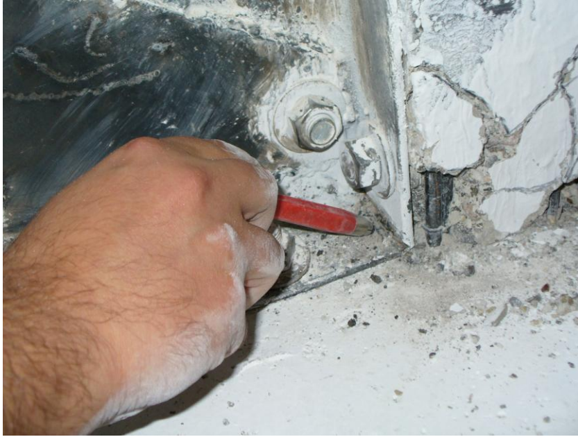
Resim 4.26. 16. çevrim sonunda sağ alt köşe yırtılma detayı
