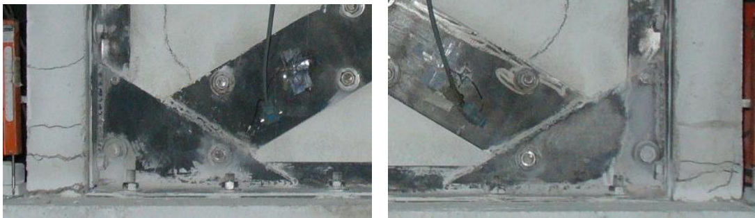
Resim 4.22. 16. çevrim sonunda sol ve sağ kolon alt ucundaki hasar
