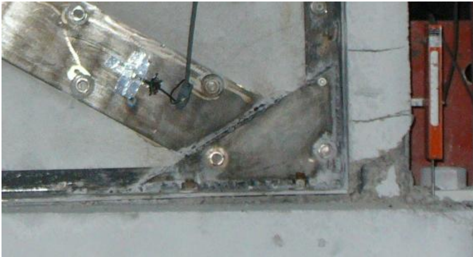
Resim 4.19. 13. çevrim sonunda sağ kolon-temel birleşiminde gelişim gösteren hasar
