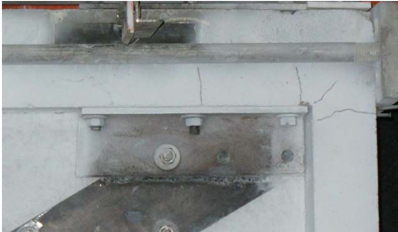
Resim 4.3. Kolon-kiriş birleşiminde çatlak.
