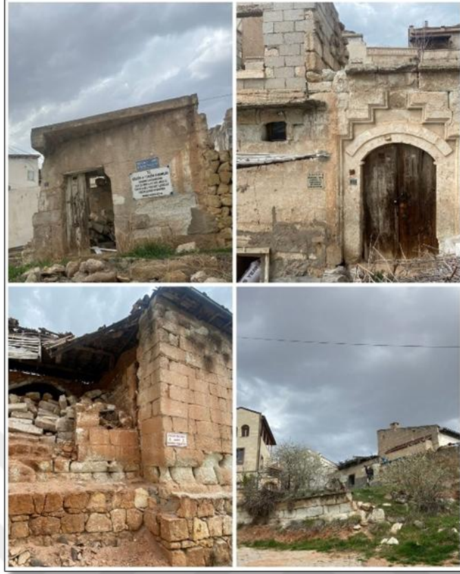
Şekil 4.22: Eski Avanos'taki Yıkılma Tehlikesi Bulunan Yapılar (Yazarın kendi arşivinden)
