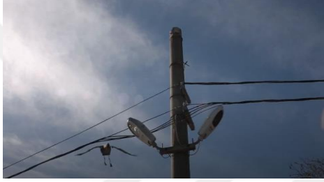
Görsel 4.31. Elektrik telleri
