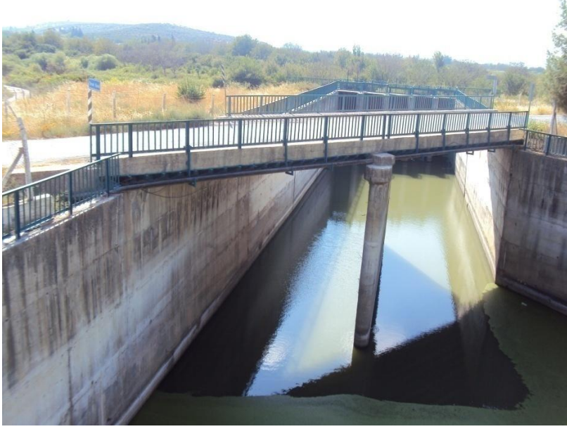
Yarseli Barajı Pompa İstasyonu, Hatay- 14 Eylül 2012
