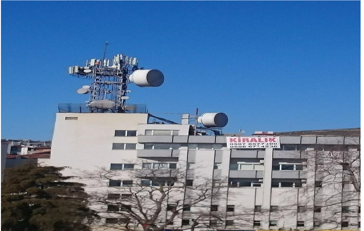
Şekil 5. Uğur Mumcu Meydanı PTT İl Müdürlüğü binasında bir baz istasyonu
