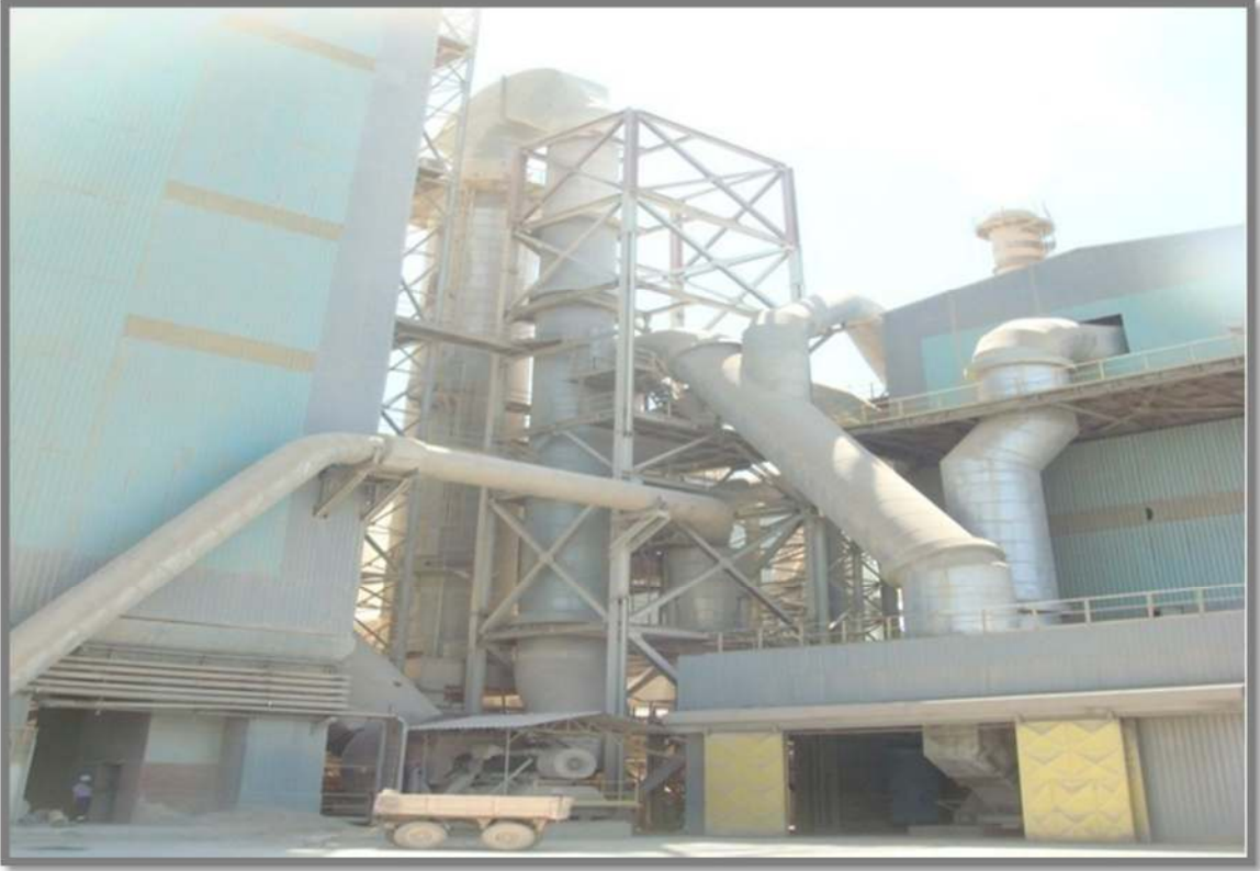
Foto 7: Farin ve Fırın Arasındaki Sıcak Gaz Hatları
