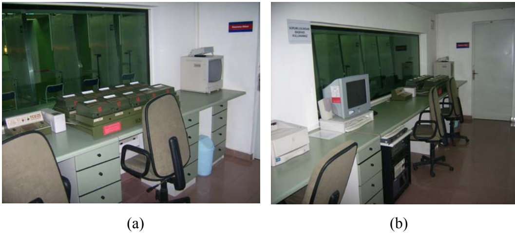
Resim 5.12. Kontrol odası a) Kontrol odası b) Kontrol odası
