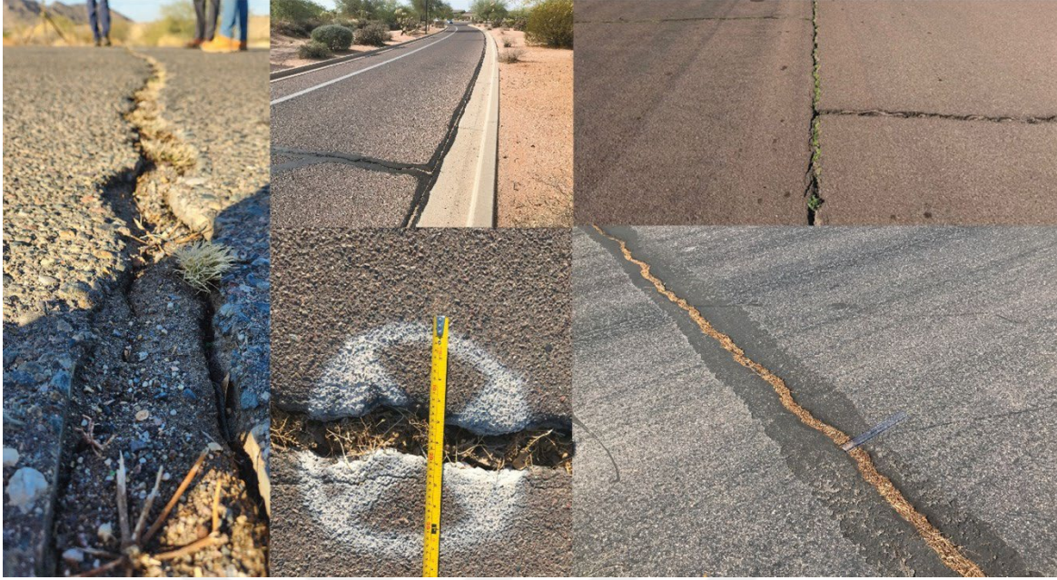
Şekil 2.15: Düşük sıcaklık çatlaması
