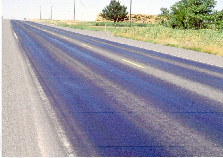
Şekil 2.10: Asfalt kaplamada terleme veya kuma
