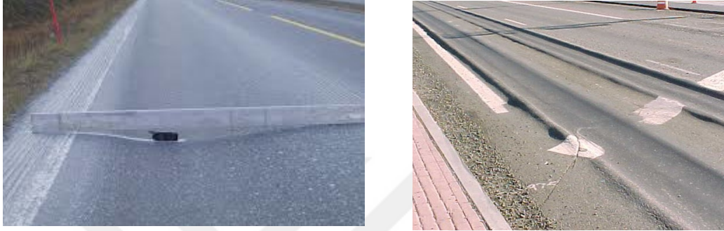
Şekil 2.13: BSK kaplama içerisinde tekerlek izi oluşumu
