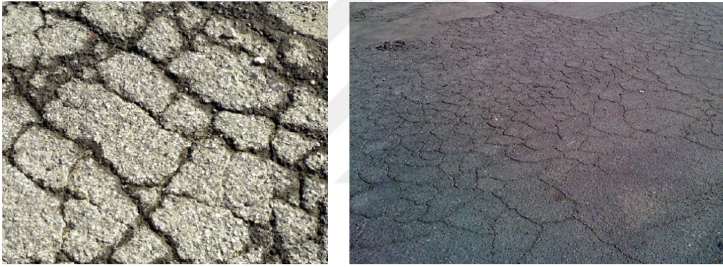
Şekil 2.9: Timsah sırtı çatlaklar
