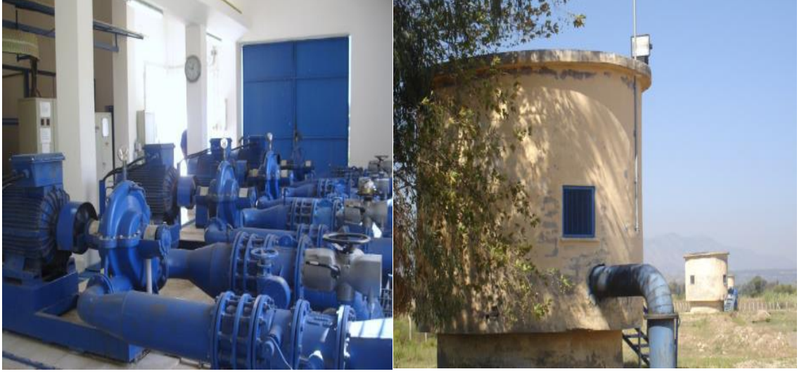
Şekil 3.63. Boğaçay pompa istasyonu (Yılmaz 2011)
