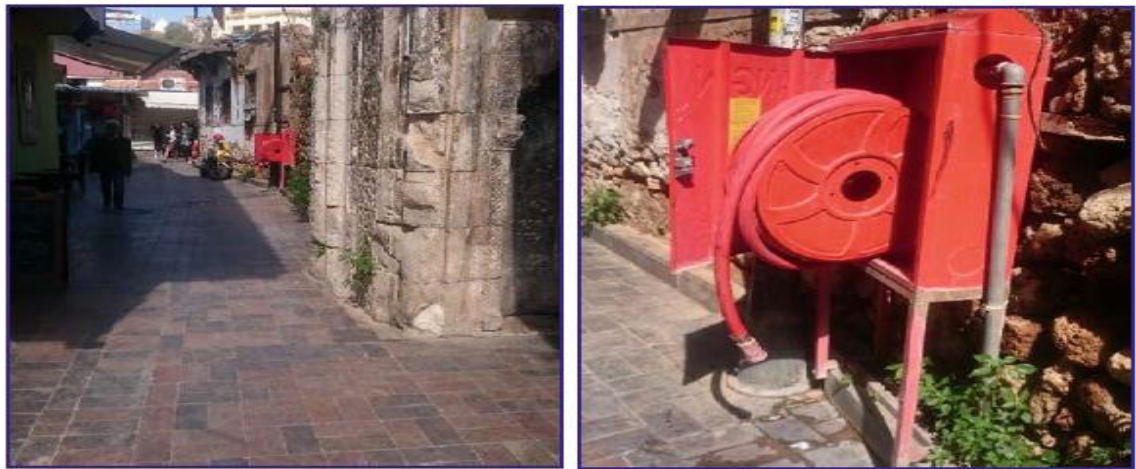
Şekil 3.53. Bölgede kullanılan yangın dolaplarına ait ekran görüntüsü (Muhammetoğlu 2017)
