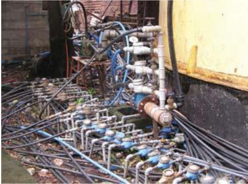
Şekil 3.22. Sayaç kurulumunda yapılan hata örneği (Farley vd. 2008)
