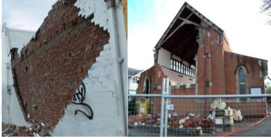
Şekil 1.3 Christchurch depreminde düzlemsel dışı göçen yığma duvarlar (Dizhur ve diğer., 2011)
