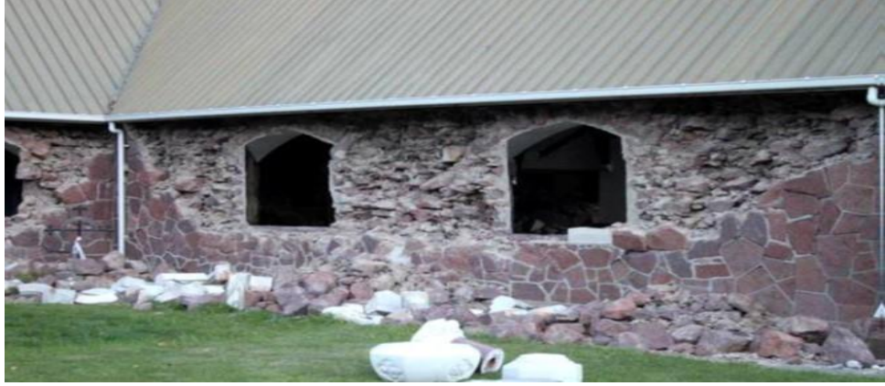
Şekil 1.5 Christchurch depreminde düzlemdışı göçen üç tabaklı taş yığma (Dizhur ve diğer., 2011)
