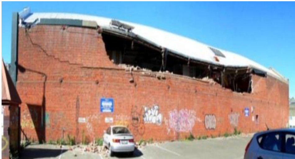
Şekil 1.4 Christchurch depreminde düzlemsel dışı göçen tuğla yığma duvar ((Dizhur ve diğer., 2011)
