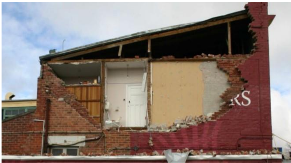
Şekil 1.2 Canterbury depreminde düzlemsel dışı hasar oluşan iki yapraklı duvar (Dizhur ve Ingham, 2015)
