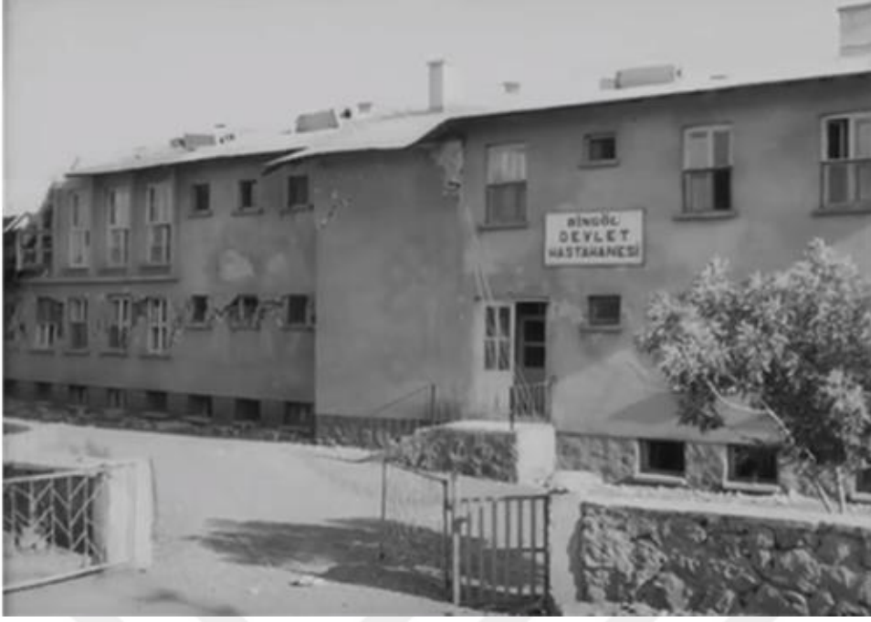
Şekil 3.5. 1971 Bingöl depremi sonrası hasar gören Bingöl Devlet Hastanesi (T.C. Kültür ve Turizm Bakanlığı, 1971).
