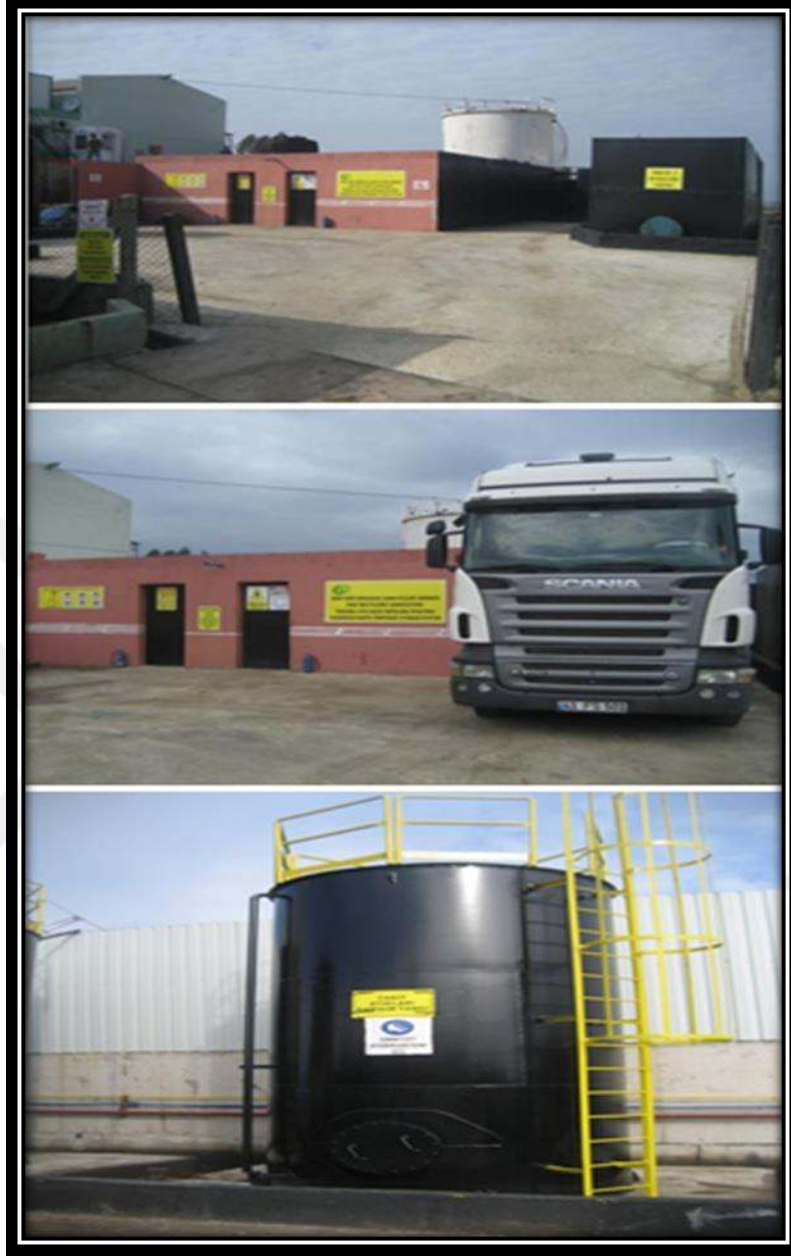
Şekil 28: Tehlikeli Atık Depoama İstasyonu Görünümleri
